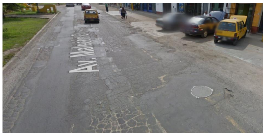
Figura 2. Baches en la av. Malecón Checa
