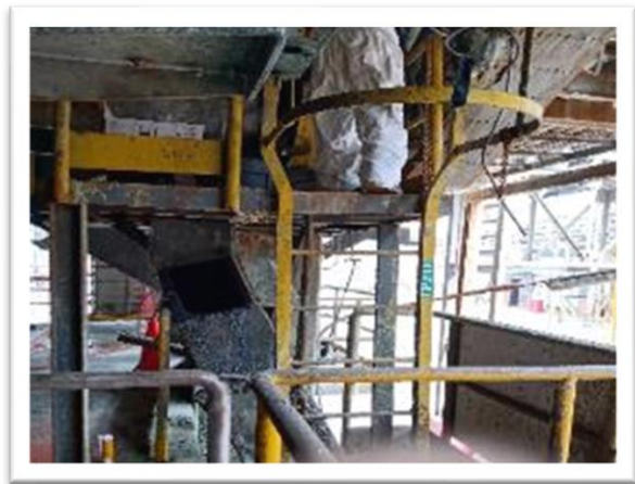
Figura N°2: Acto Subestandar - Personal no utiliza arnes de seguridad
