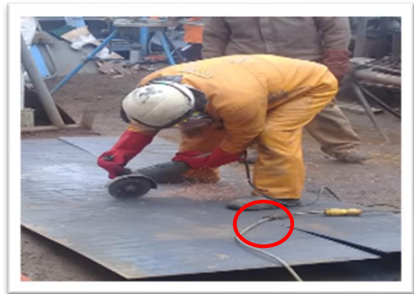
Figura N°4: Condición Subestandar – Cable Eléctrico energizado dañado.
