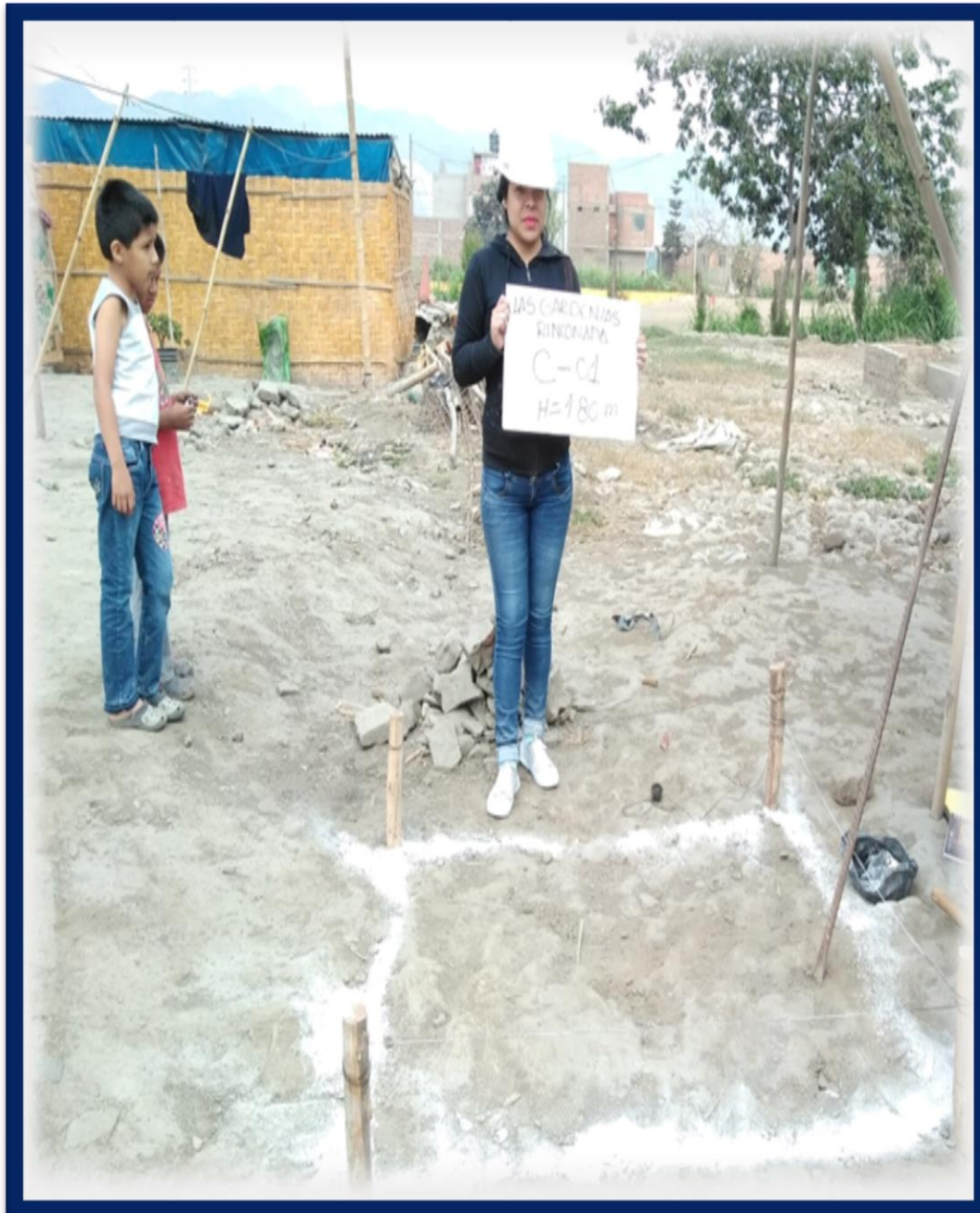
FIGURA N°07: SE OBSERVA LOS TRABAJOS PRELIMINARES PARA REALIZAR LA EXCAVACIÓN DE LA MUESTRA #°01
