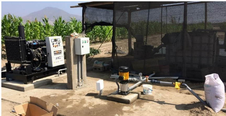
Figura 10 Sistema de control de regadío por goteo Fuente: elaboración propia
