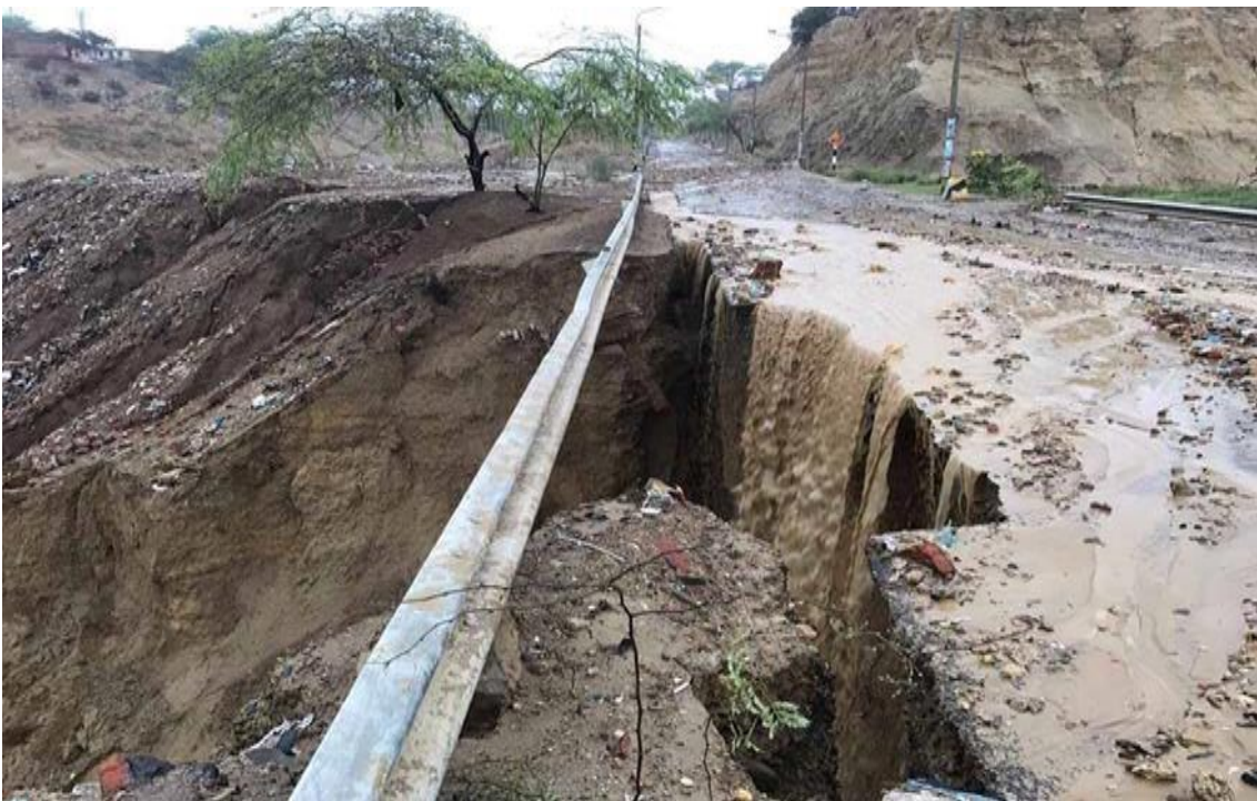
Figura 13: Carretera Piura – Paita destruida en el año 2017
