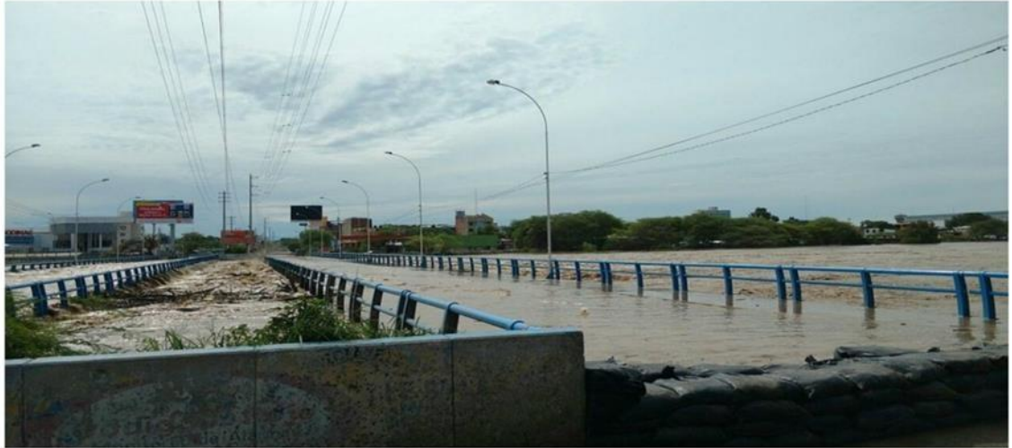
Figura 17: Vista del cuarto puente de Piura, en su máximo caudal del día 27/03/2017 (desborde del Rio Piura).
