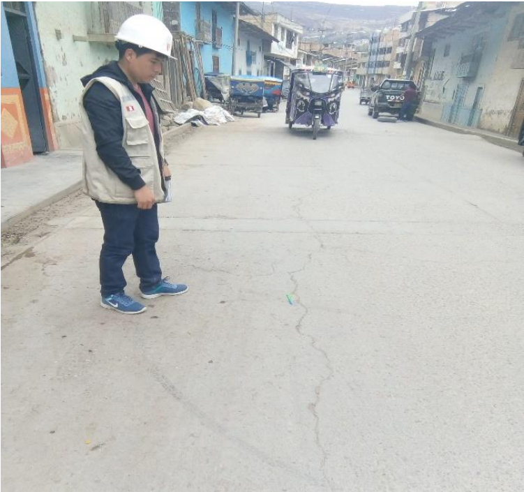
IMAGEN 5: Aquí se muestra la losa que presenta una falla de grieta lineal con una severidad baja ya que la abertura es menor a 12mm
