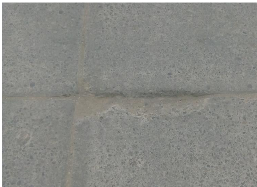
Ilustración 7: Falla sello de junta
