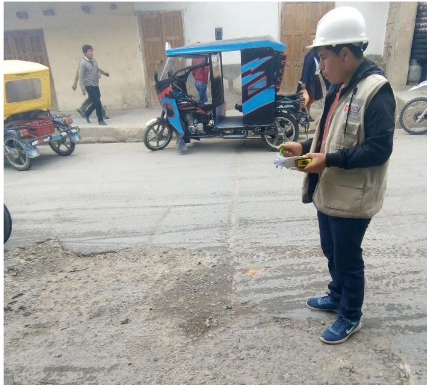
IMAGEN 10: Esta losa tiene una falla de desconchamiento con una severidad alta ya que está presente en más del 15% del área.
