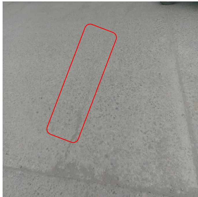
Ilustración 8: Falla grieta lineal
