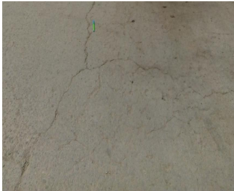
Ilustración 5: Falla de grieta de durabilidad "D"
