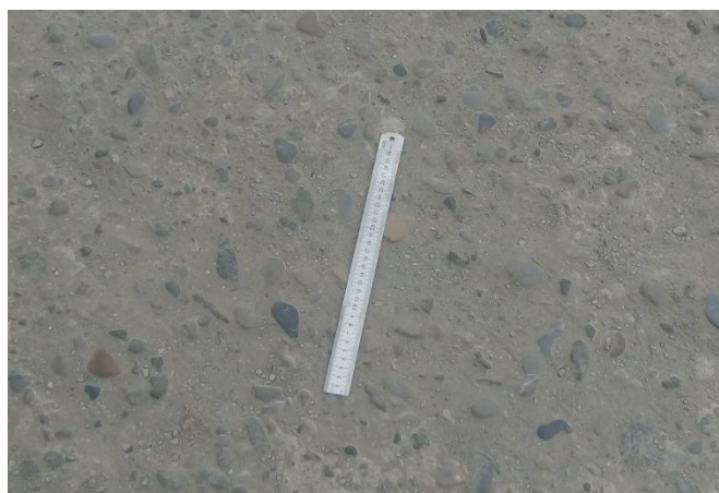
Ilustración 10: Falla pulimiento de agregados
