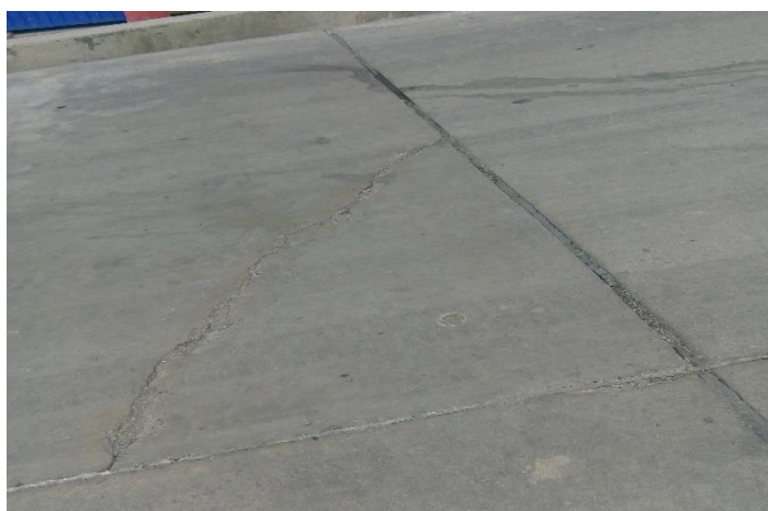
Ilustración 3: Falla grieta en esquina
