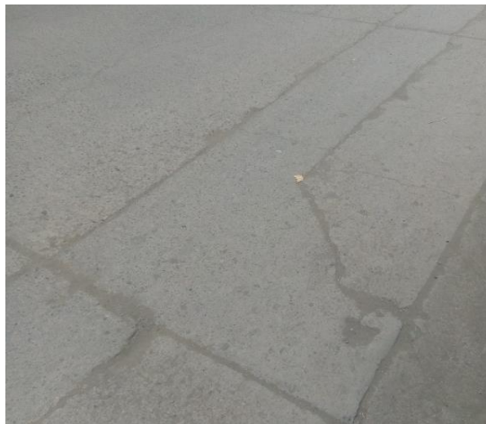
Ilustración 9: Falla parche grande
