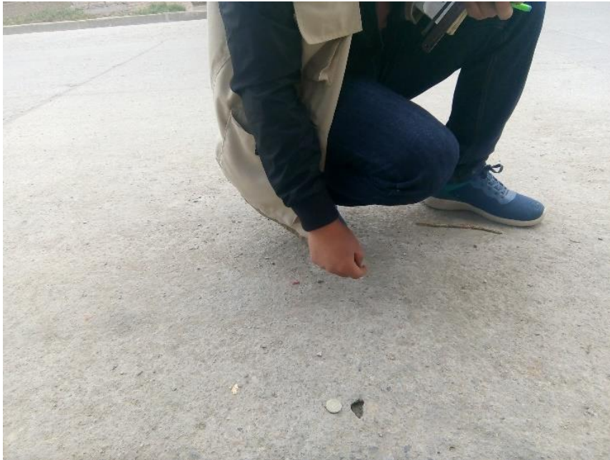
IMAGEN 9: Se observa en esta imagen la falla popouts, la cual no tiene un grado de severidad.
