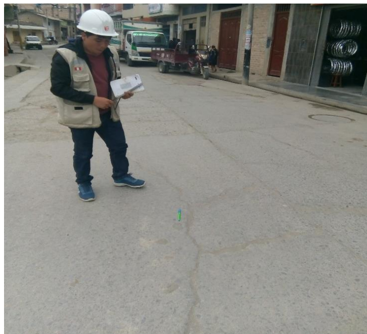
Ilustración 4: Falla losa dividida
