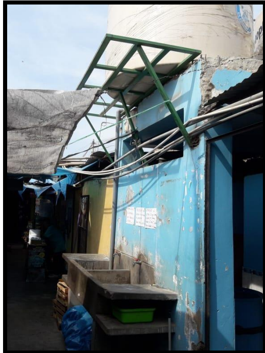
Foto 24 Instalación de agua
