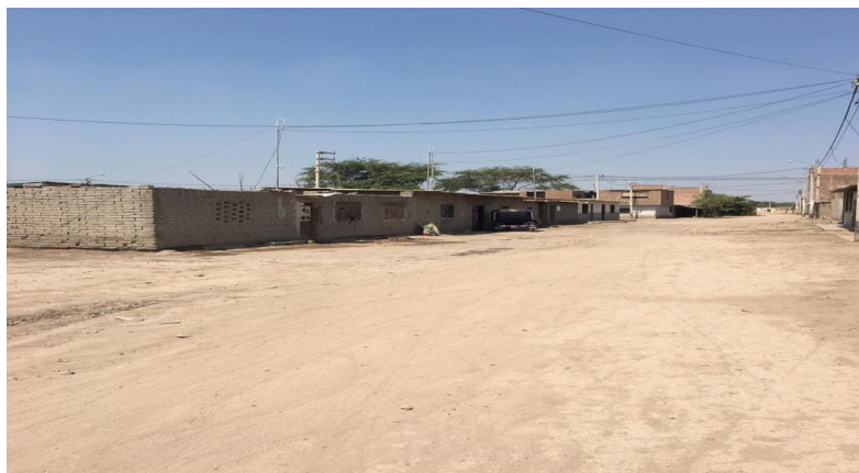
Figura 1: Estado actual de las vías de Sector Pampa El Toro, Tután.
