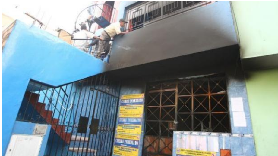
Figura 76: Los centros de Rehabilitación cuentan con materiales inflamables y no cuentan con extintores. Fuente: diario la industria.
