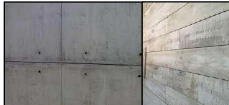
Concreto expuesto Fuente: Nembra.net
