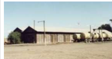
Antiguos almacenes en mal estado Fuente: Red Provincial del Patrimonio
