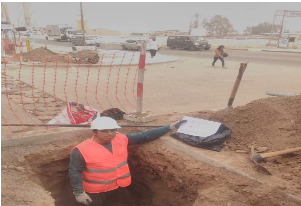
Panel fotográfico 10. Calicata en la Avenida Pachacútec para la obtención del valor de CBR Fuente: Propia
