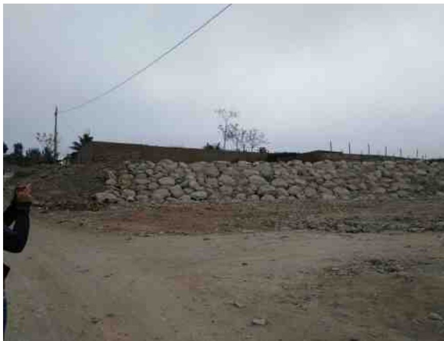
Foto N°3: Faja marginal de quebrada San Carlos
