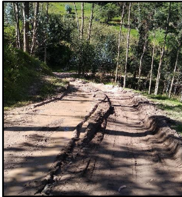
FOTO 02: Estado actual de la carretera Otuzco – Caserío Carata.
