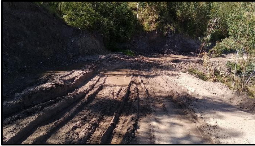
FOTO 01: Estado actual de la carretera Otuzco – Caserío Carata.
