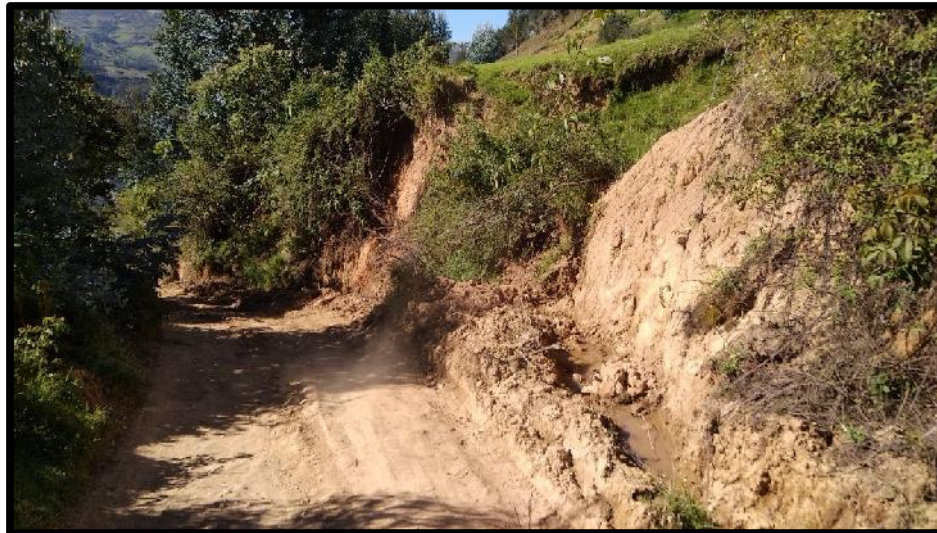
FOTO 04: Plataforma en mal estado de la carretera Otuzco – Caserío Carata, se proyectaran alcantarinas de paso y de alivio.
