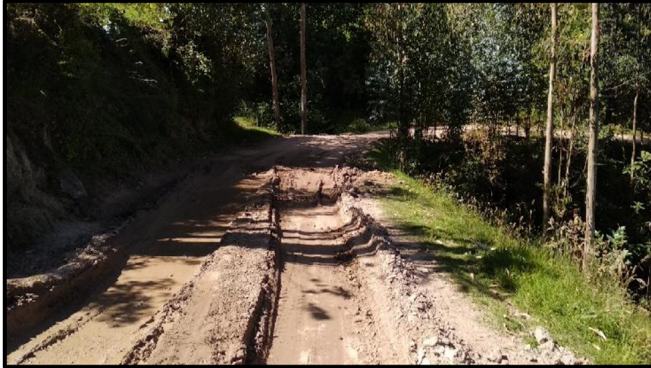
FOTO 03: Ahuellamiento en la carretera Otuzco – Caserío Carata, se proyectaran cunetas.
