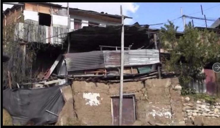
Figura 3: Vivienda en colapso
