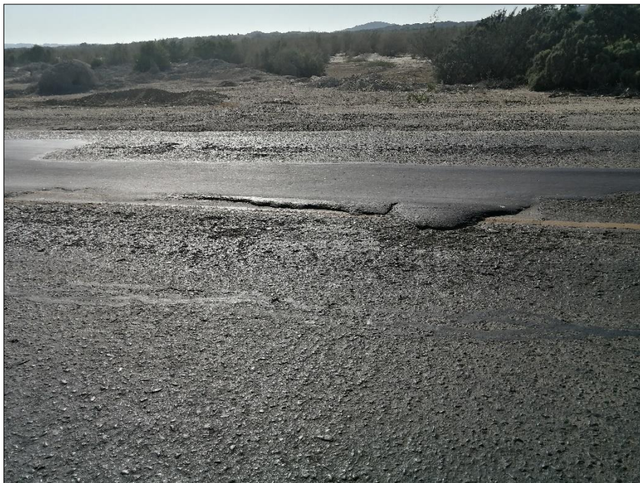
Figura 39. Abultamientos y Hundimiento
