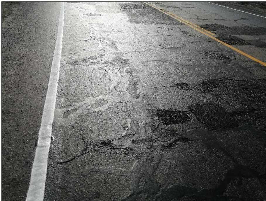
Figura 43. Abultamientos y Hundimiento – piel de cocodrilo
