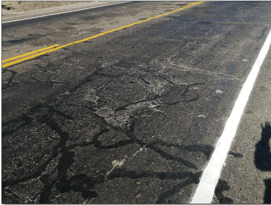
Figura 42. Piel de cocodrilo y fisuras
