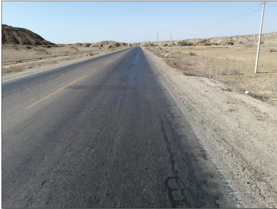
Figura 32. Fisuras transversales - Parcheo
