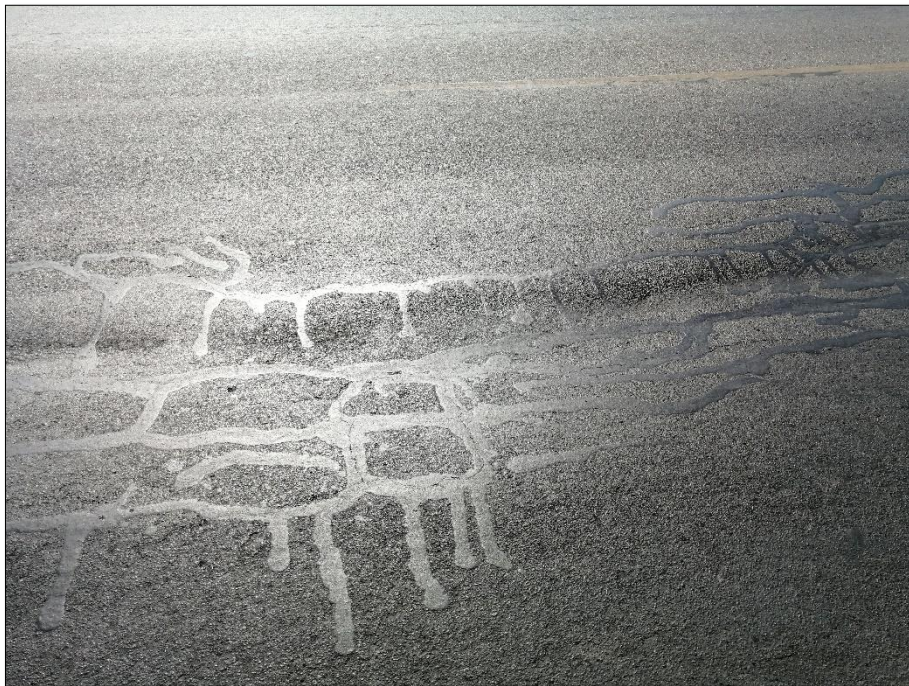
Figura 33. Abultamientos y Hundimiento
