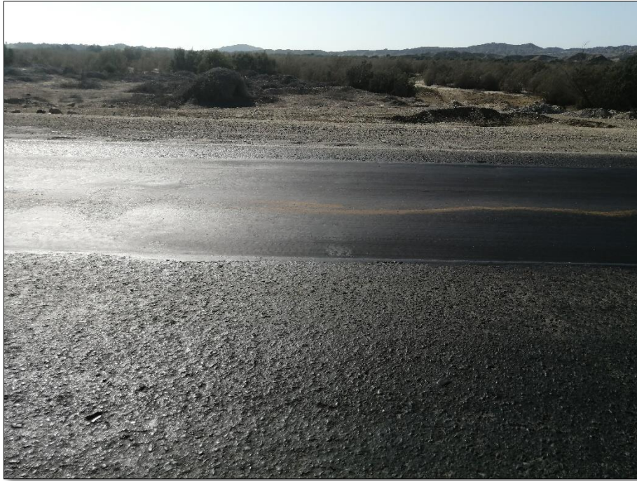
Figura 38. Desprendimiento de agregados – piel de cocodrilo
