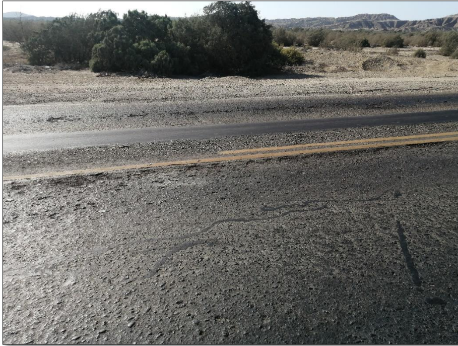
Figura 40. Abultamientos y Hundimiento – piel de cocodrilo
