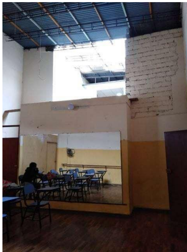
Figura 12. Salón de práctica en malas condiciones
