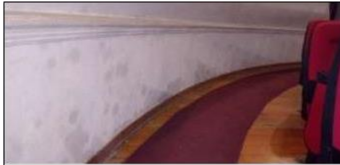
Figura 25. Evidencia de paredes deterioradas por humedad Fuente: Elaboración propia
