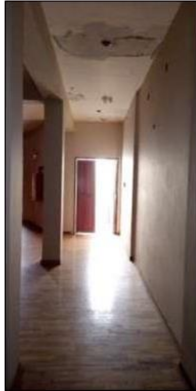
Figura 22. Fisuras en los techos del tercer nivel Fuente: Elaboración propia
