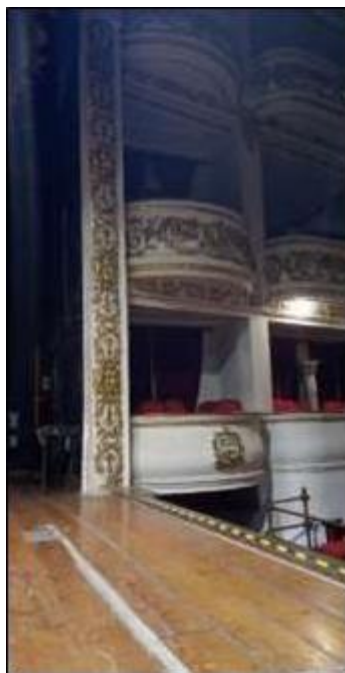
Figura 23. Escenario con piso de madera en mal estado Fuente: Elaboración propia
