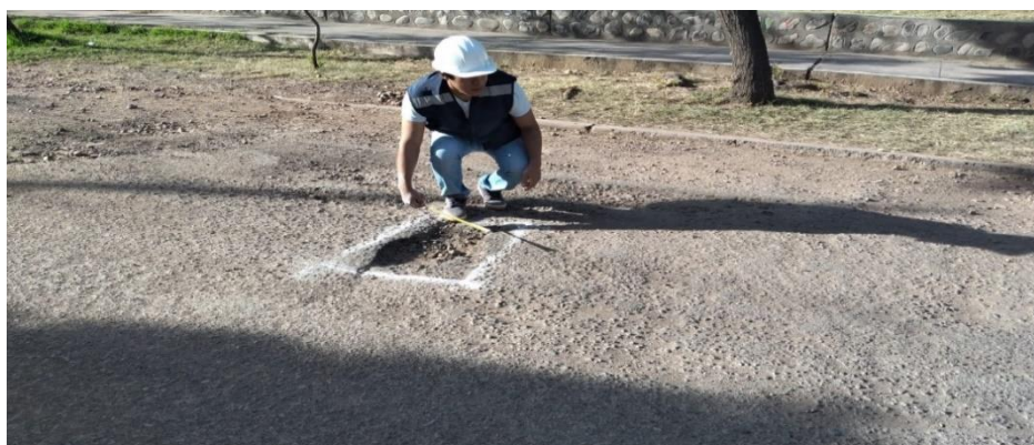
Figura 45: Evaluación de la falla hueco
