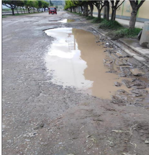
Figura 1: Fallas del pavimento Flexible
