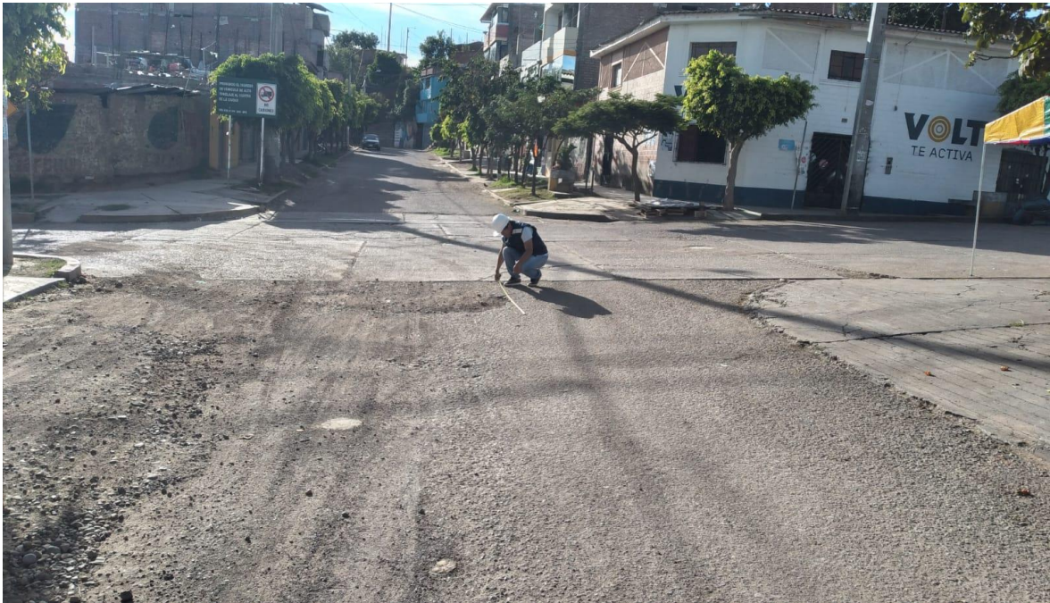
Evaluación de las anomalías del pavimento.
