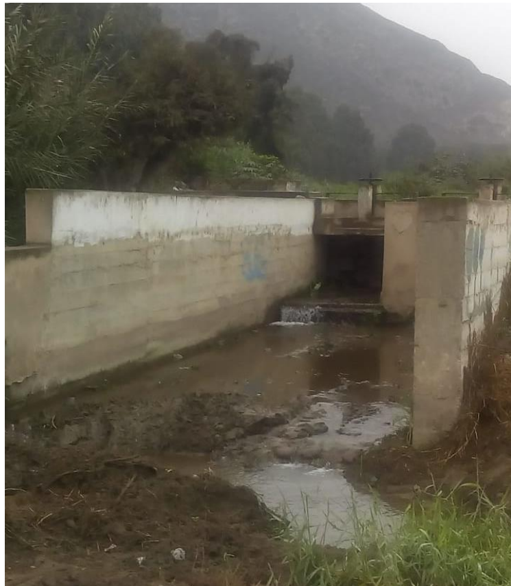
Figura 64: Acumulación de maleza en las compuertas de entrada a la bocatoma
