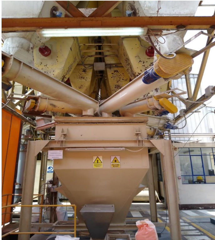
Anexos N° 4:A.4. Fotografía: Tolvas o silos de la planta el molino El Milagro
