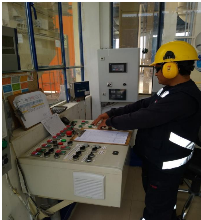
A.5. Fotografía: Control y monitoreo por pulsadores
