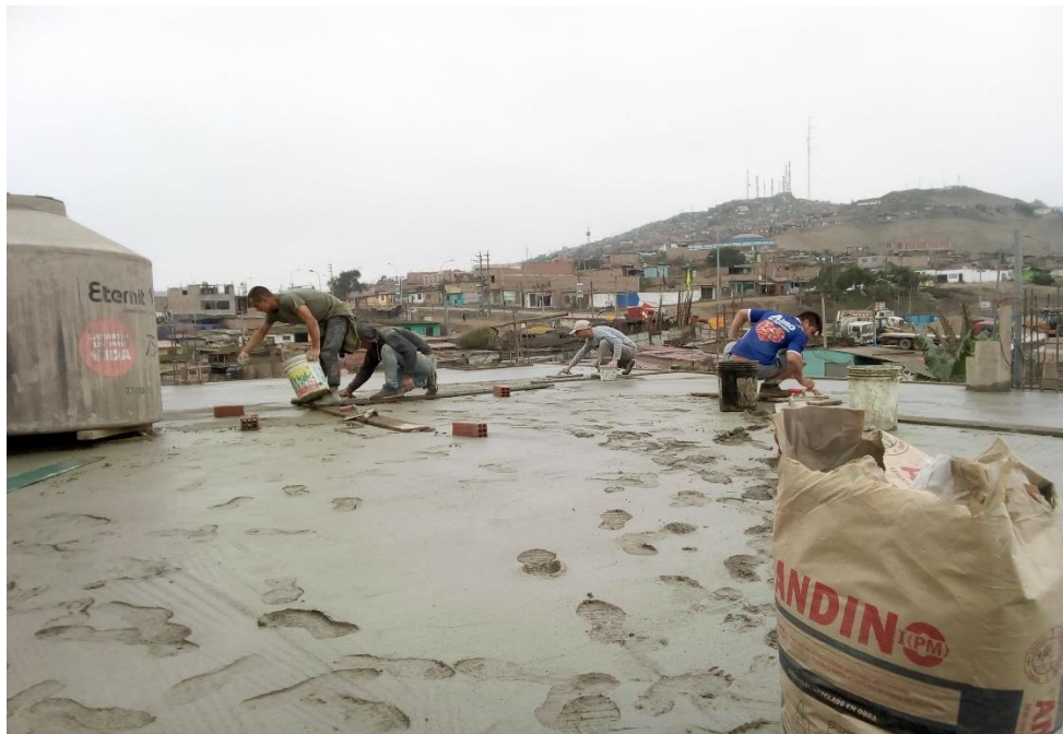
Figura 6. Mal Proceso Constructivo
