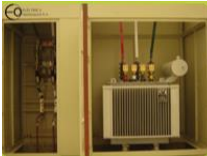
Figura 7. Trasformador en marcha
