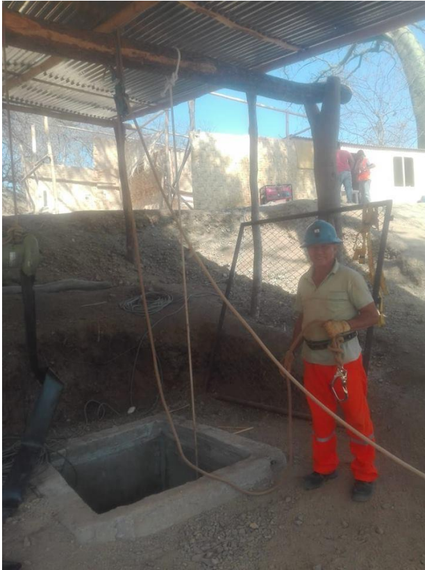
Figura N°06. Trabajador verificando la instalación del arnés en el Pique 51. Fuente: propia del autor.
