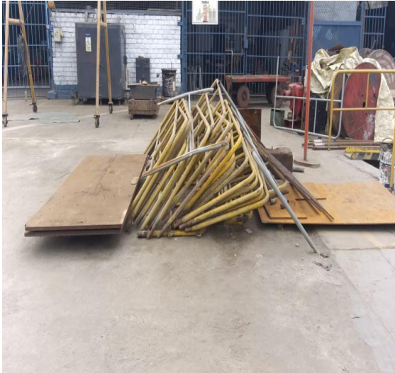
Figura 5. Desorden el área de trabajos mal apilados
