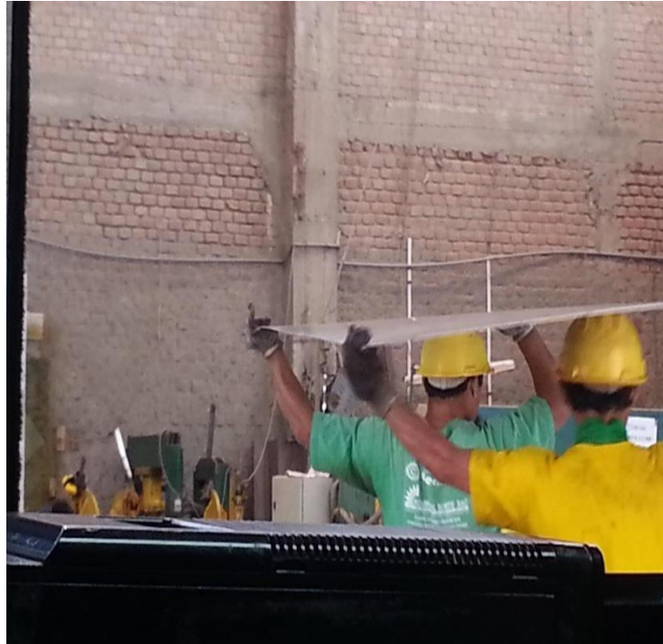
Figura 8. Manipulaciones de la maquinaria sin protección (A través de las charlas de 5 minutos diarios estaremos previniendo estas faltas y posibles accidentes o incidentes) Fuente: Elaboración propia
