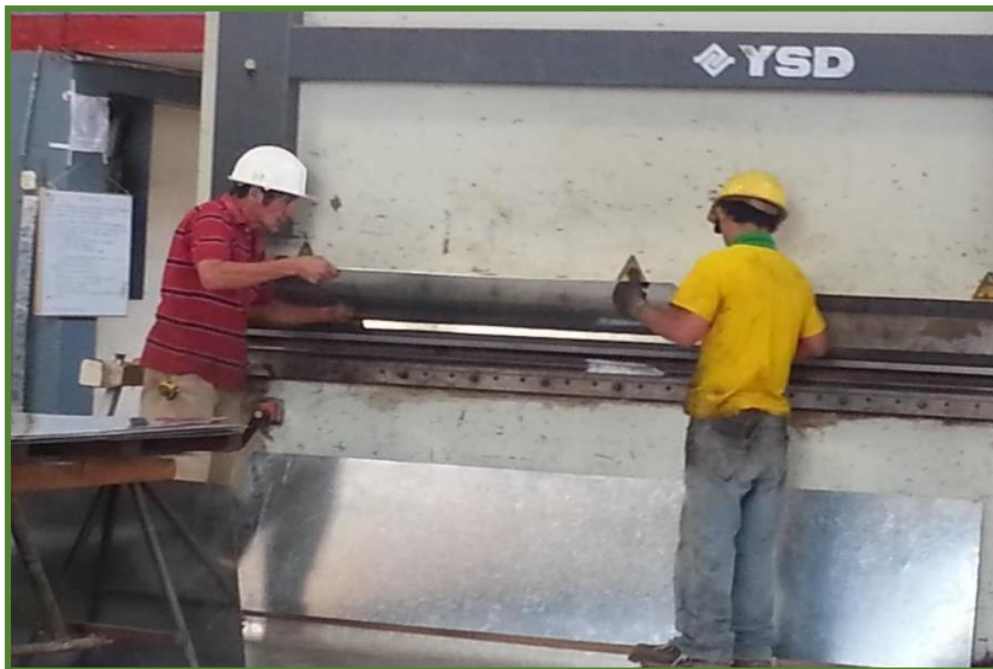
Figura 9. Manipulaciones de la maquinaria sin protección (la falta de guantes y zapatos industriales los cuales nos previene de riesgos y peligros) Fuente: Elaboración propia
