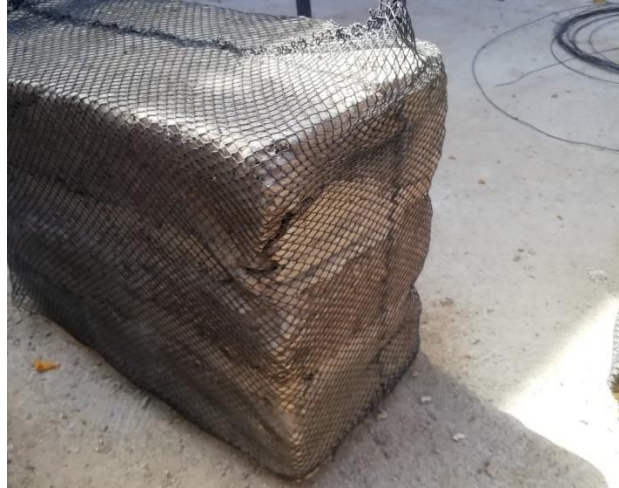
Figura 55: Reforzamos la pila de adobe con geomalla para su empastado, repetimos el proceso para las 4 pilas
