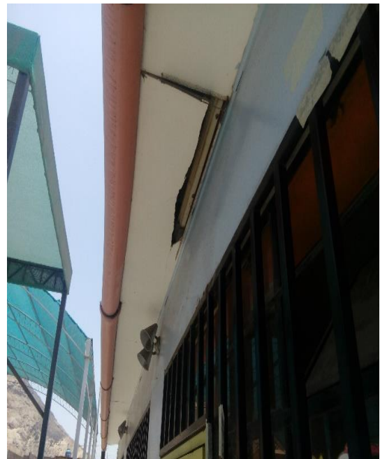
Figura 8. Instalaciones eléctricas y sanitarias como también cubiertas en mal estado.
