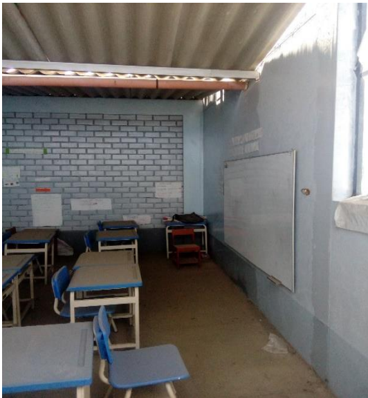
Figura 3. Falta de infraestructura escolar y medidas peligrosas para los alumnos y administrativos.
