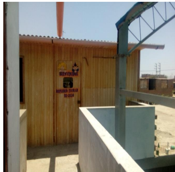
Figura 1. Deterioro de muros e instalaciones en aulas pedagógicas de algunos centros Educativos de La Esperanza.
