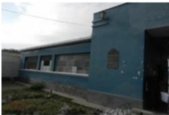
Figura: Evidencia de vanos en mal estado. Fuente: Propia (2019).
