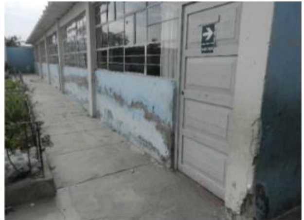
Figura: Estado deficiente de las aulas. Fuente: Propia (2019).
