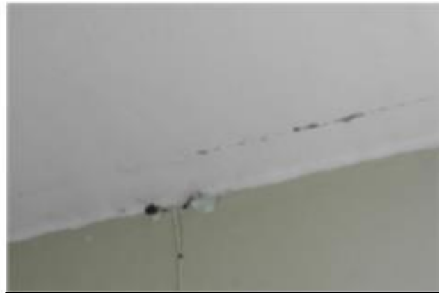
Figura: Evidencia de cableado expuesto. Fuente: Propia (2019).
