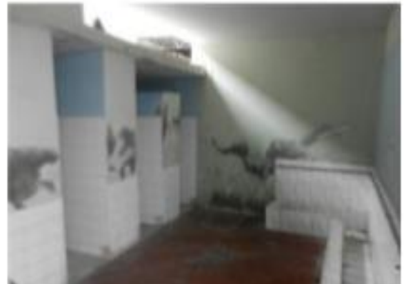
Figura: Estado actual de los servicios higiénicos Fuente: Propia (2019).
