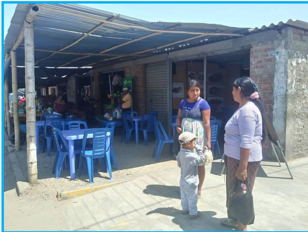
Figura 33. Fotografía del estado de los techos, además esta parte no cuenta con un cerramiento, como se puede apreciar en la imagen las personas están consumiendo los productos que ofrece el mercado, pero con contacto directo con la calle, puesto que se encuentran paradas en la vereda.
