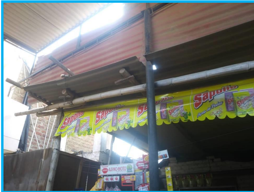
Figura 34. Fotografía de los soportes estructurales de algunos puestos de venta, como se puede apreciar en la imagen, estos son de fierro galvanizado no brindando ninguna garantía en caso de un sismo.
