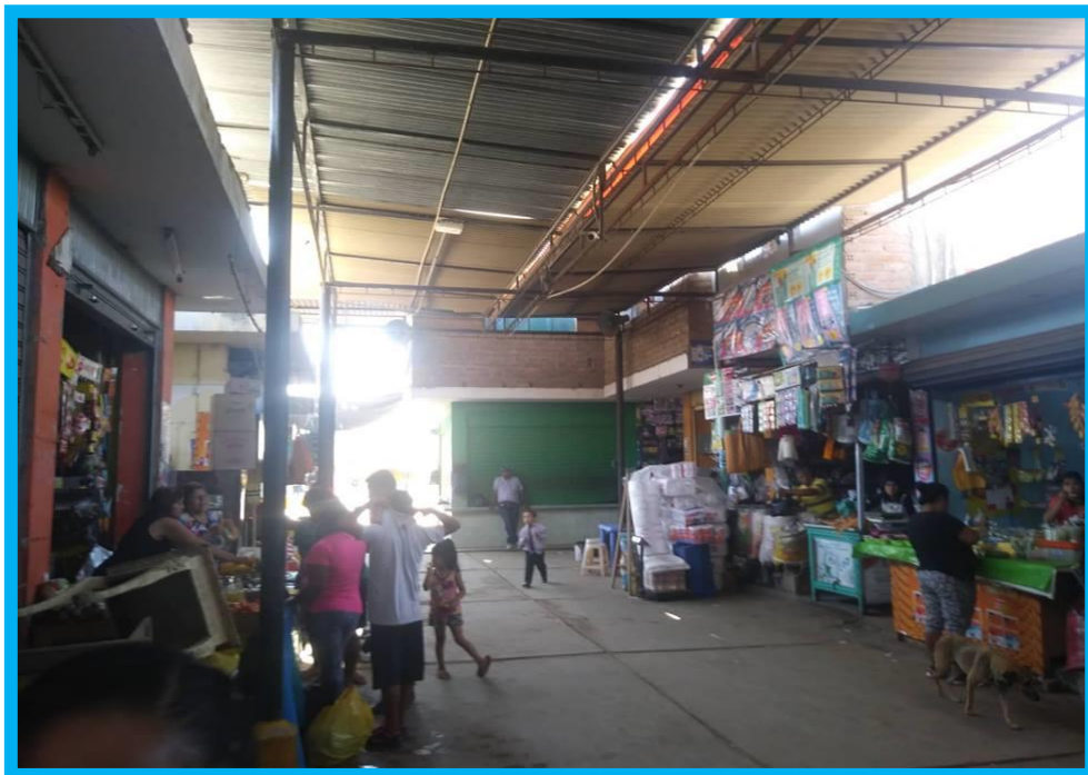
Figura 29. Fotografía del techo en malas condiciones del mercado, motivo por el cual cuando se producen lluvias, los alimentos tienden a malograrse por el pase de la humedad.
