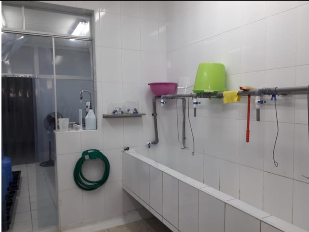
Figura 17. Zona de lavado de la empresa Aqua Poseidon, Chiclayo Fuente: Elaboración propia
