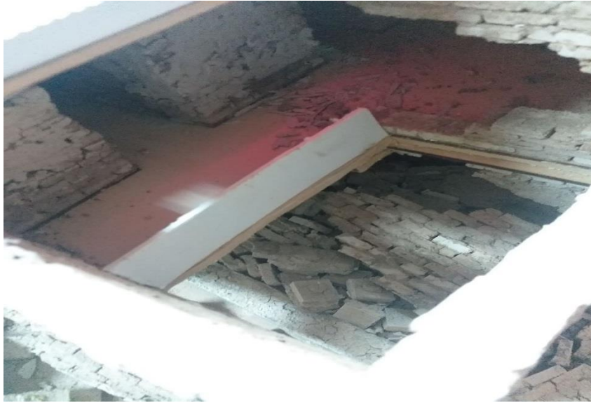
Figura 95. Rotura y colapso de los muros interiores del primer nivel del espécimen de adobe sin refuerzo. Fuente: Imagen propia, 2019
