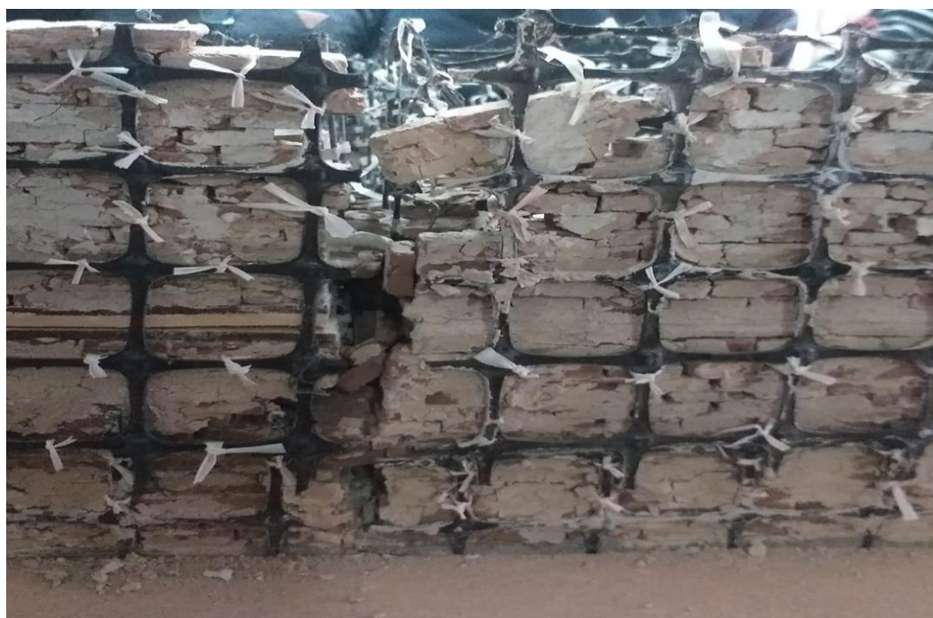
Figura 124. se aprecia muros laterales colapsados en el segundo nivel como también la falla de la junta sísmica del espécimen reforzado con geomalla. Fuente: Imagen propia, 2019
