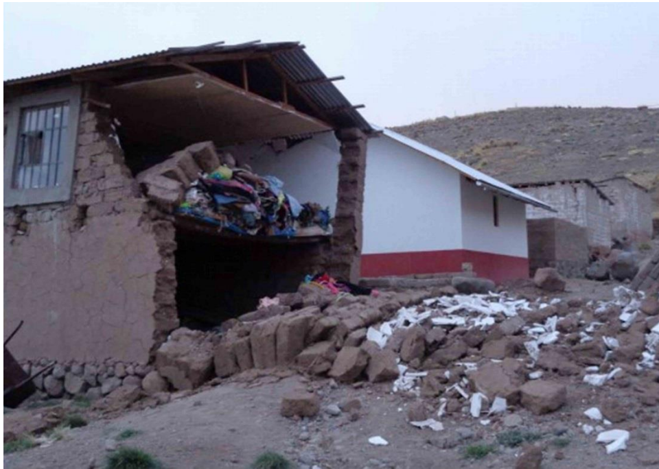
Figura 1. Colapso de vivienda de adobe convencional en Cuzco.
