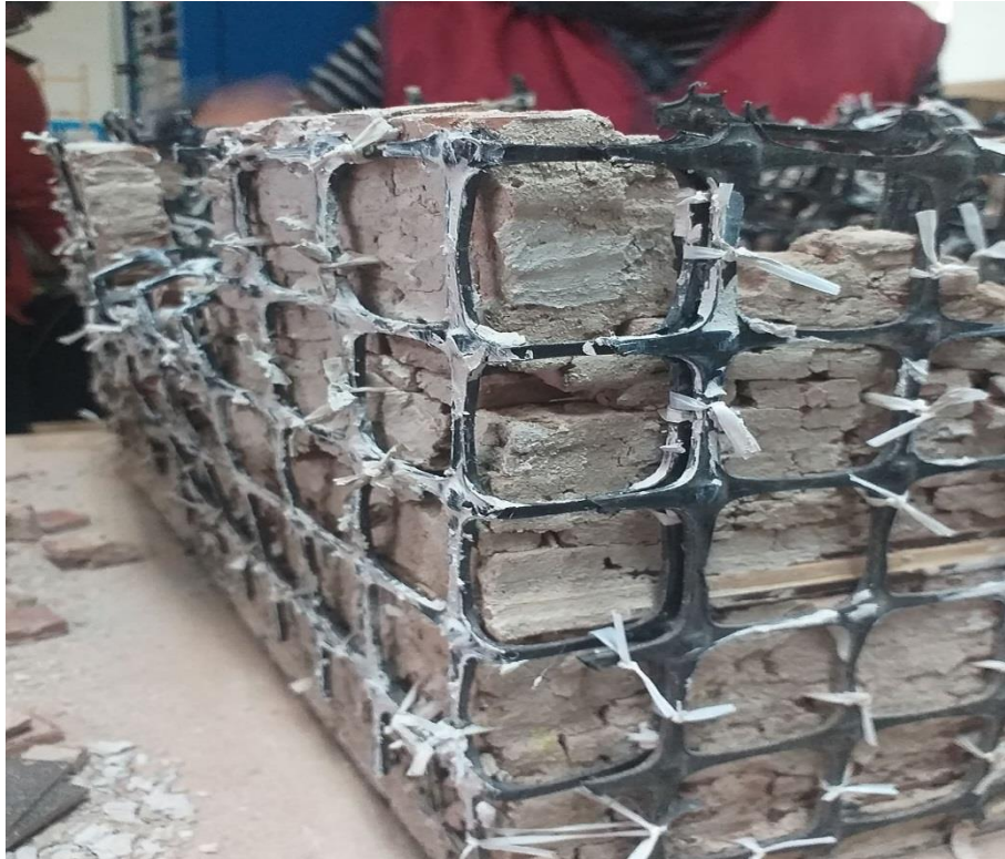
Figura 125. se aprecia falla en los muros esquineros en el segundo nivel del espécimen reforzado con geomalla. Fuente: Imagen propia, 2019
