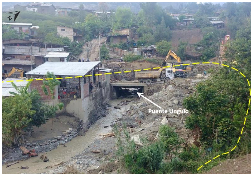
Figura 24: Material acarreado por el flujo de detritos (huayco), obstruye el Puente Ungulo, y el material transportado pasa sobre él, destruyendo y afectando viviendas encontradas en su en ambas márgenes de su trayecto.
