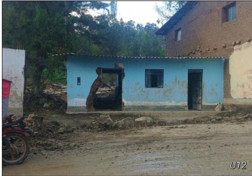
Fotografía 5: Material transportado por el huayco afecta vivienda, dejándola en condición de inhabitable.
