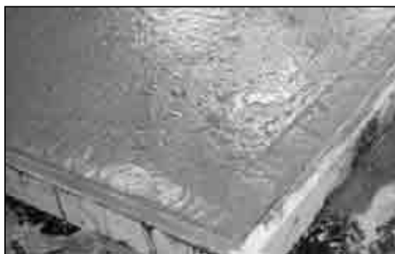
Figura 5. Exudación del concreto
