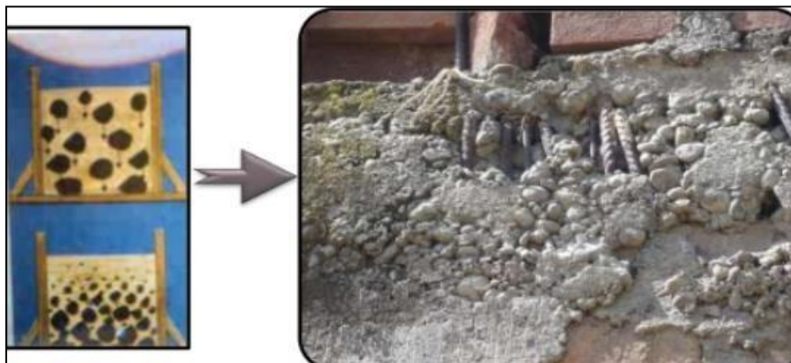
Figura 4. Segregación del concreto
