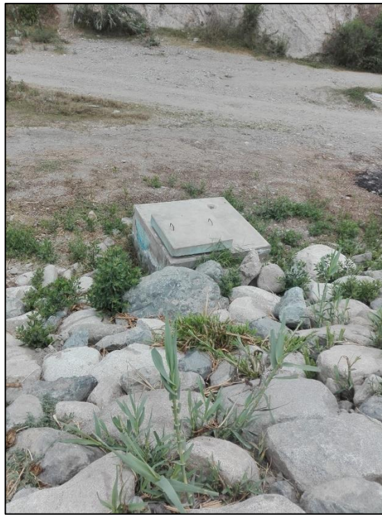
Figura 30 : Captación existente en estado de deterioro, tapa en mal estado.
