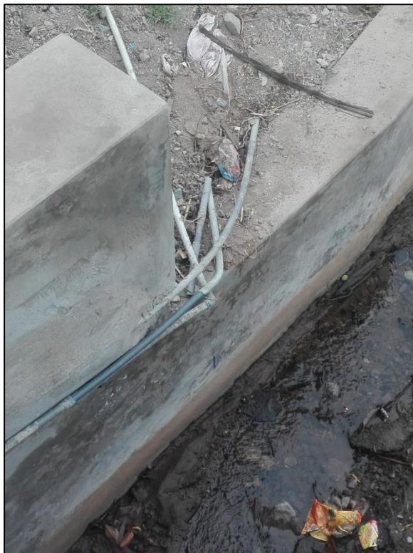
Figura 29 : Tuberías expuestas en mal estado y deterioradas.
