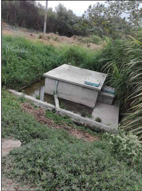
Figura 28 : Reservorio existente en mal estado ubicado en el Centro Poblado Santa Rosa
