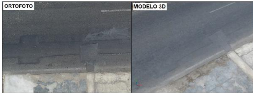
Figura 27: Falla Parcheo vista con el Drone Fuente: Cruz Toribio, Jorge Omar, 2018.
