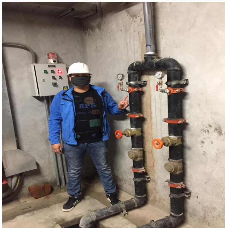
Fotografía 4. Las tuberías HDPE que de filtran el agua contra incendio del proyecto Mercado de Chancay. (Fuente: Tomado por parte propia).
