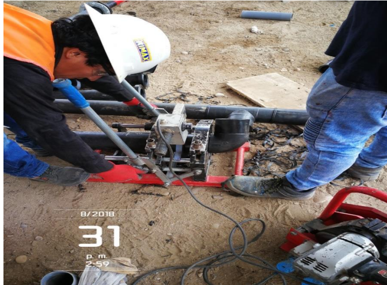
Fotografía 1. Personal haciendo la termofusión de las tuberías HDPE en el proyecto Mercado de Chancay. (Fuente: Tomado por parte propia).
