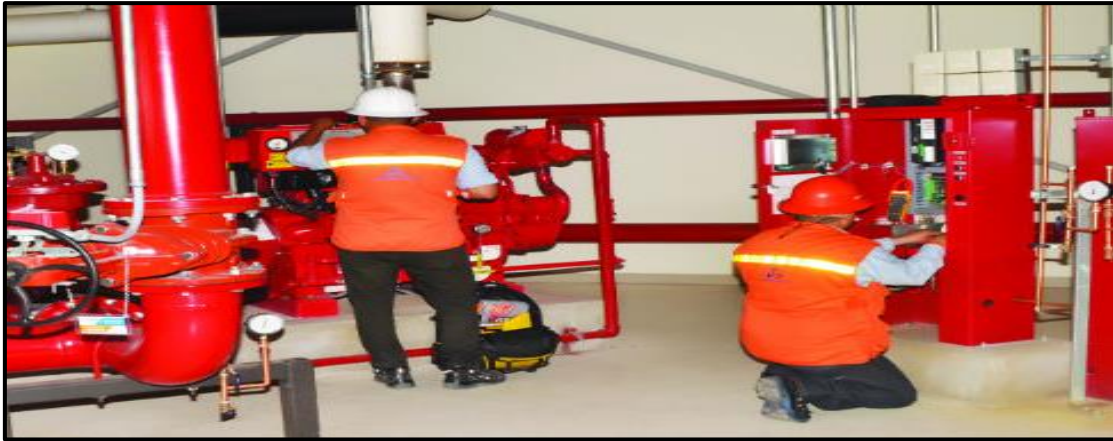
Figura 12. Seguridad en la evaluación de las redes de agua contra incendio. (Fuente: Jaime Moncada).
