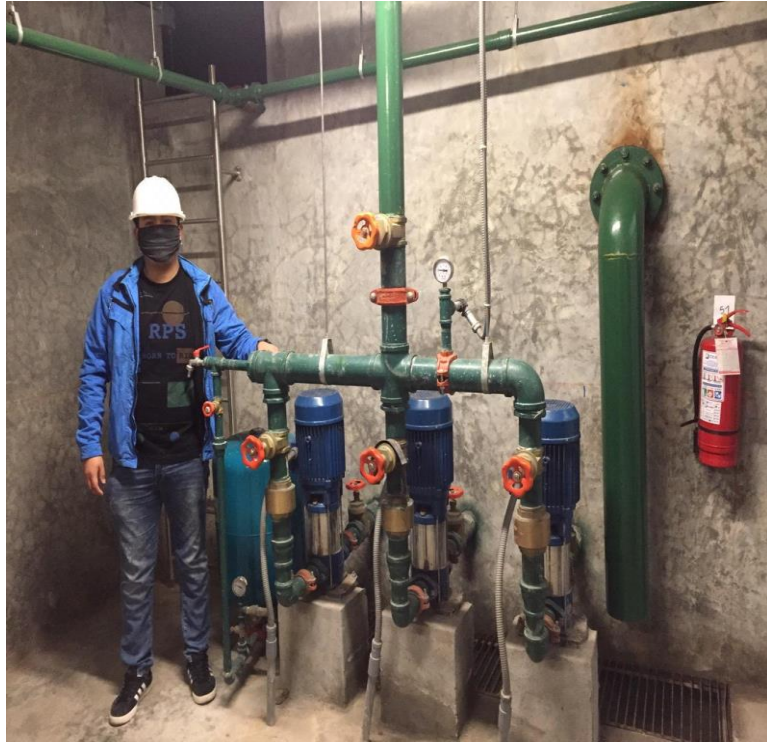
Fotografía 5. Las bombas que alimentan a las tuberías Cedula 40 y tubería HDPE del proyecto Mercado de Chancay. (Fuente: Tomado por parte propia).
