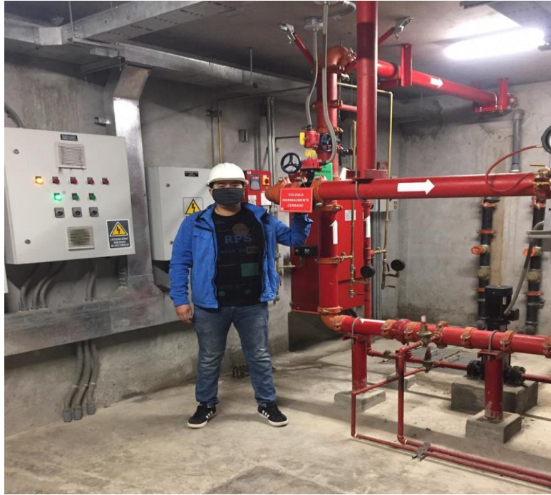
Fotografía 3. Tuberías Cedula 40 en el proyecto Mercado de Chancay. (Fuente: Tomado por parte propia).
