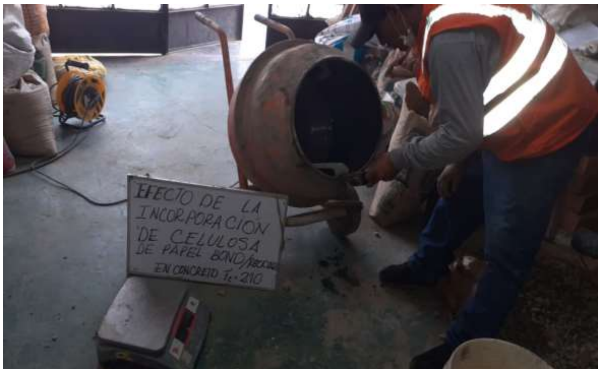
Figura: mezclado de los agregados y la celulosa reciclada con ayuda de un trompo mezclador
