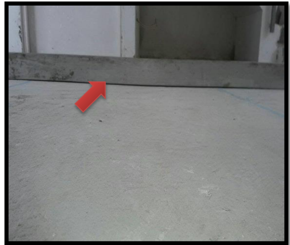
FIGURA 24: Ondulamiento de la losa - dormitorio principal
