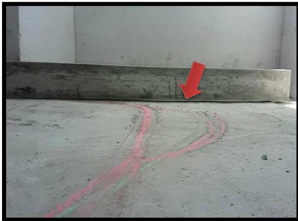
FIGURA 20: Ondulamiento de la platea de cimentación - sala
