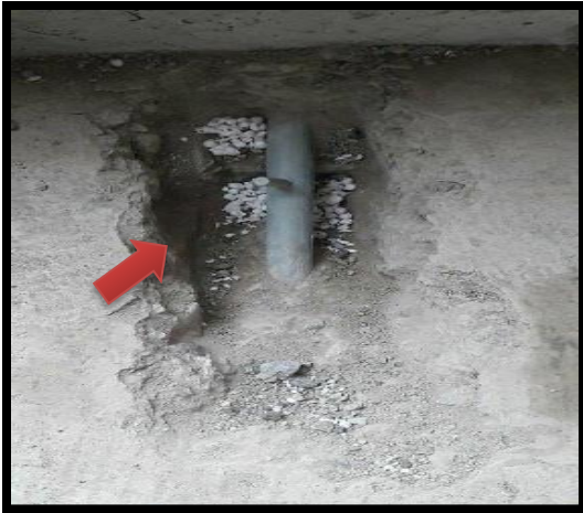
FIGURA 22: Rotura de tuberías de agua.
