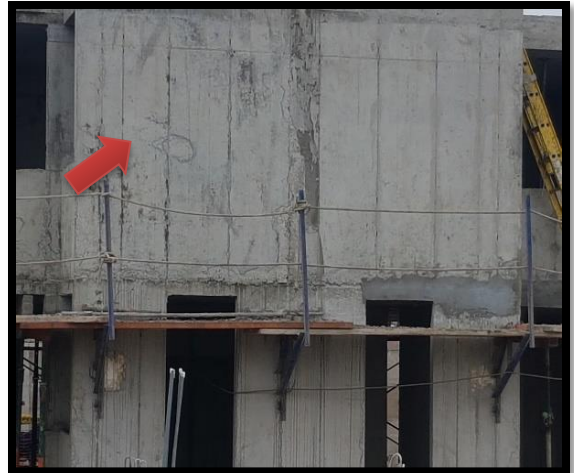
FIGURA 21: Cangrejas superficiales en las placas.
