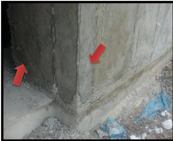
FIGURA 23: Cangrejas superficiales en las placas
