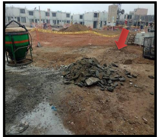
DESCIPCIÓN: Concreto desperdiciado
