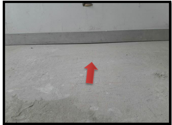
FIGURA 19: Ondulamiento de la losa - dormitorio
