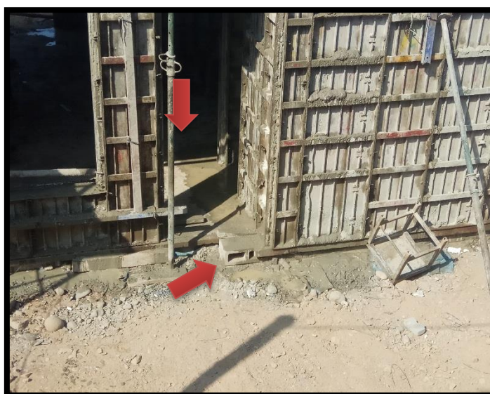
FIGURA 28: Fuga de la lechada del concreto durante el vaciado.
