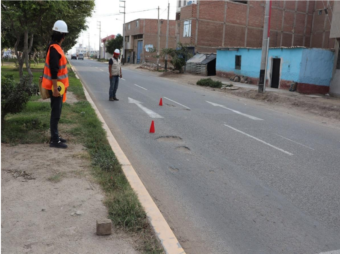
Determinación de Baches –Tramo I – Sección 1.
