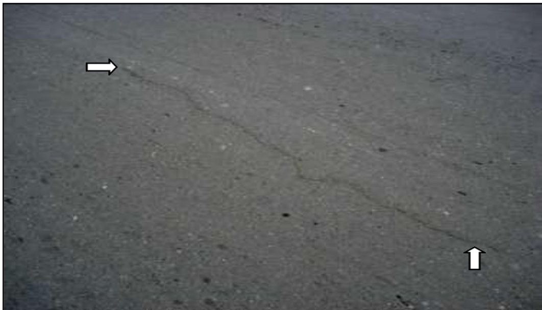
Fisuras longitudinales y transversales
