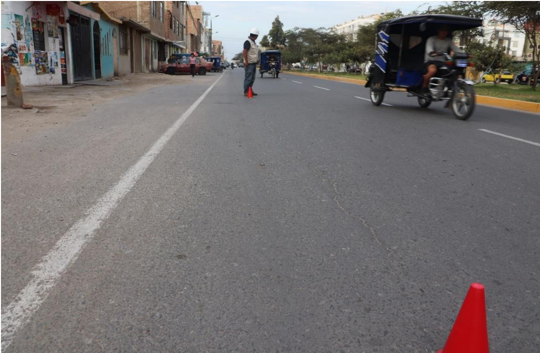
Fisuras en el pavimento.
