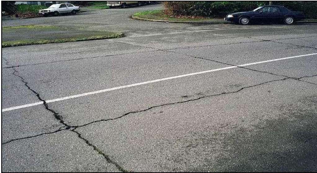
Fisura de reflexión de junta.
