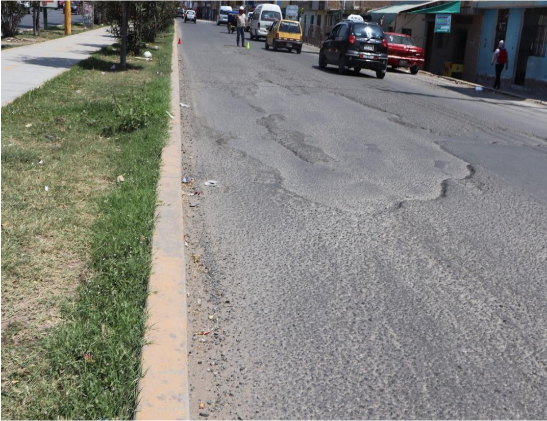
Peladura severa en el pavimento –Tramo II– Sección 2.
