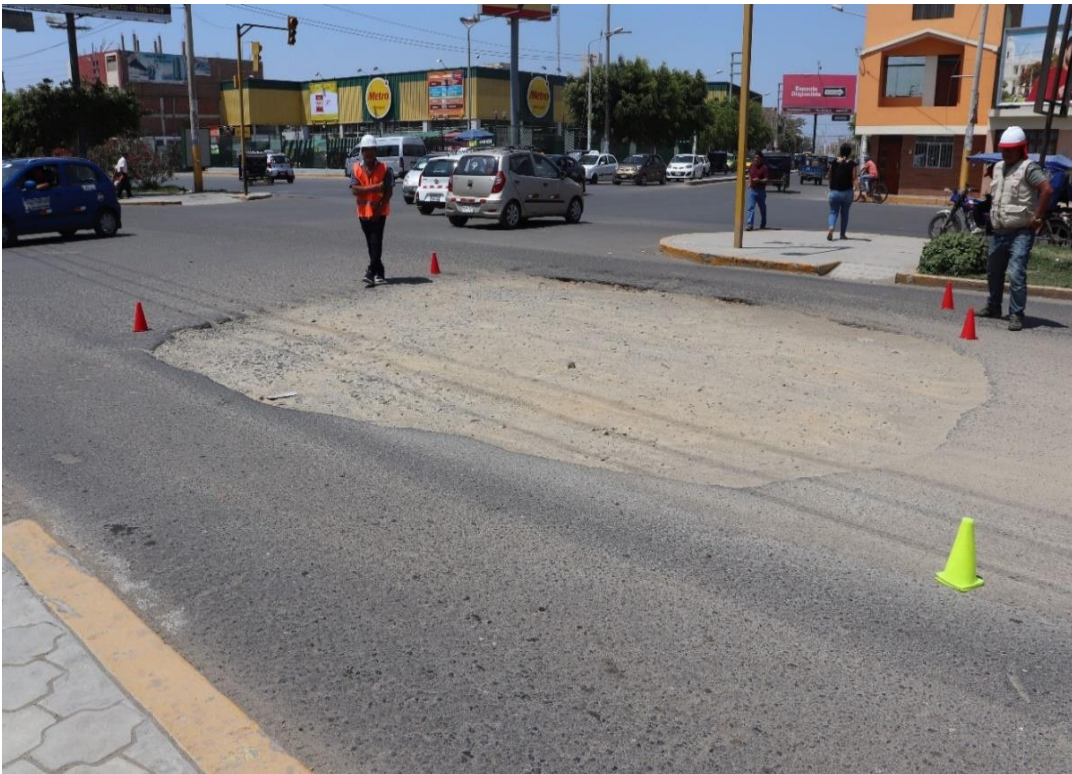
Peladura severa en el pavimento –Tramo II– Sección 3.
