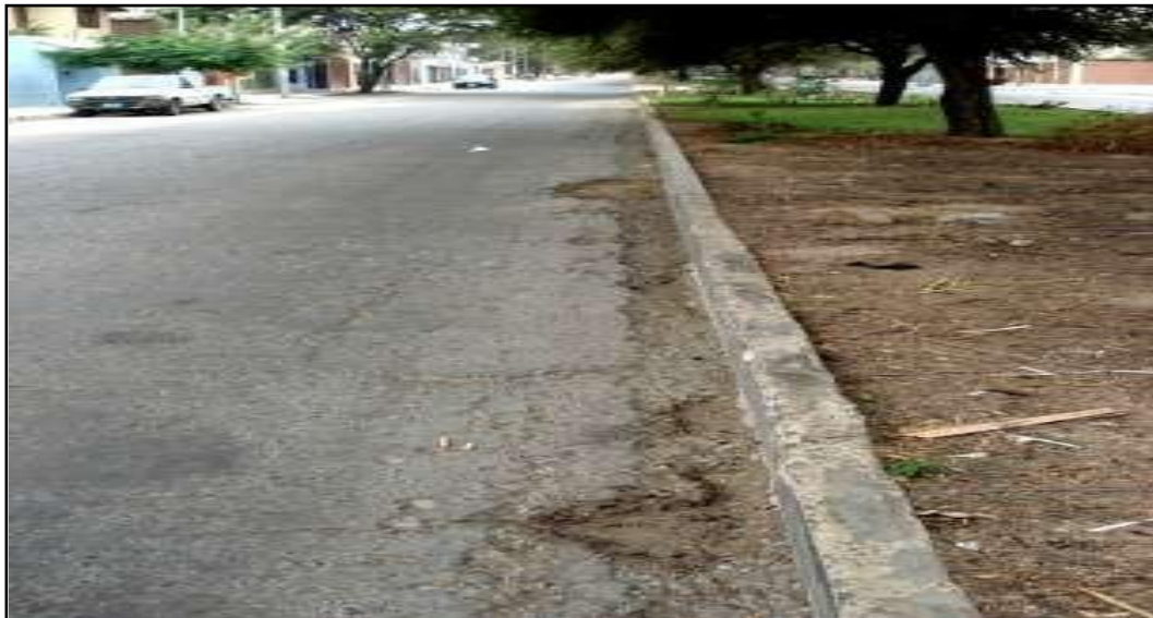
Fisuras de borde.
