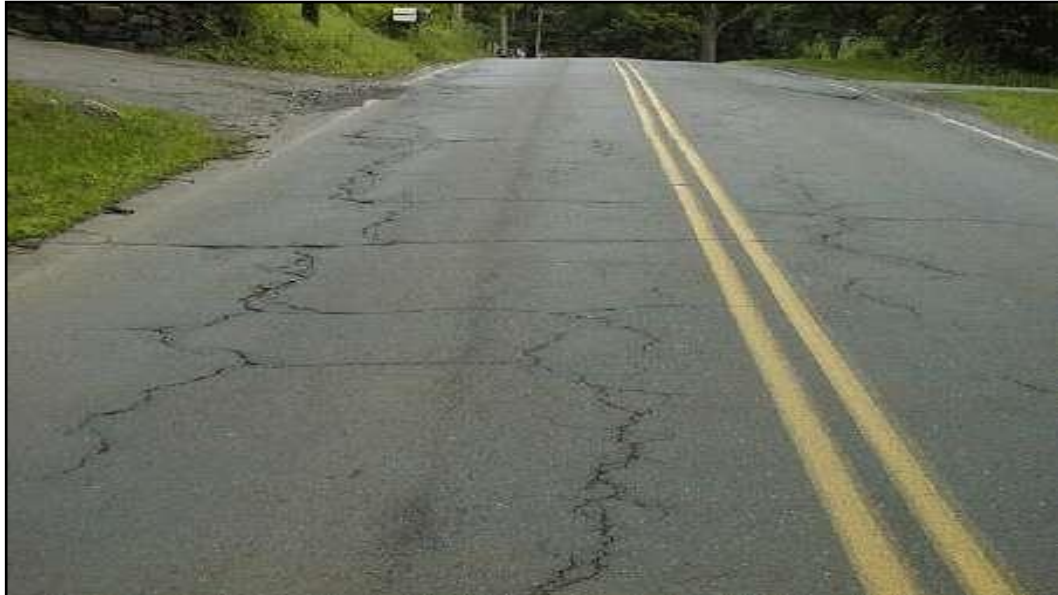
Fisuras en bloque
