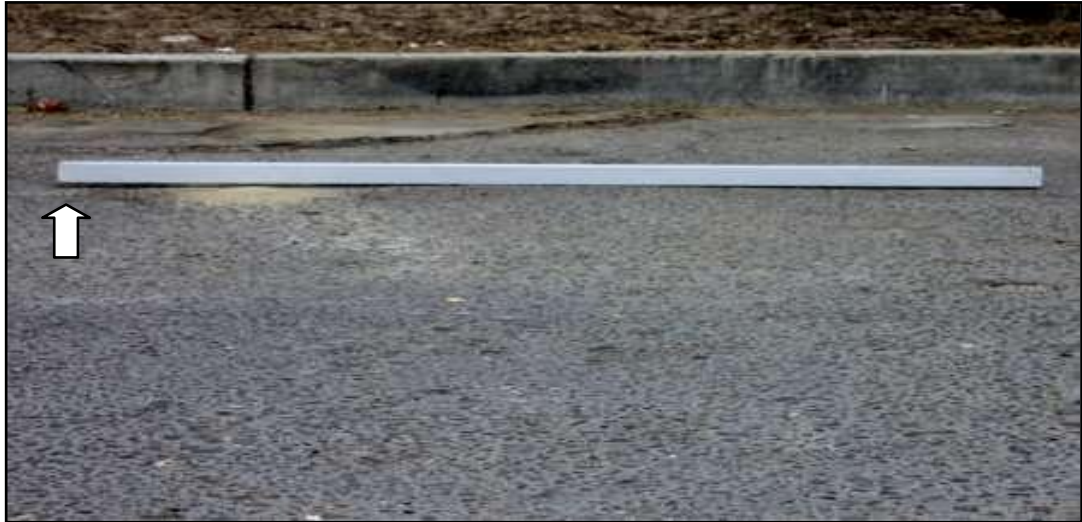
Abultamientos y hundimientos
