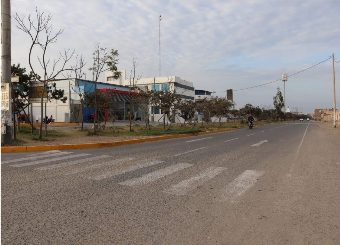
Peladura en el pavimento –Tramo I – Sección 2.
