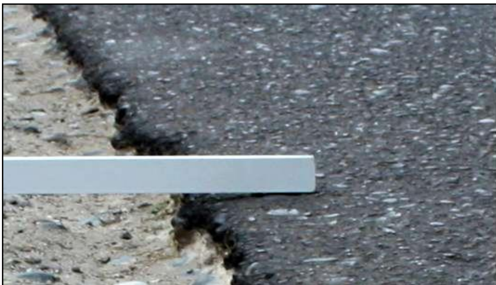
Desnivel carril – berma.
