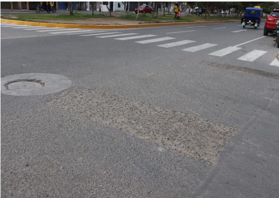
Peladura en el pavimento – Tramo I – Sección 1.
