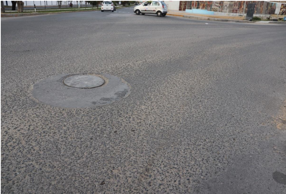
Peladura en el pavimento – Intersección de Av. Unión y Av. Miguel Grau
