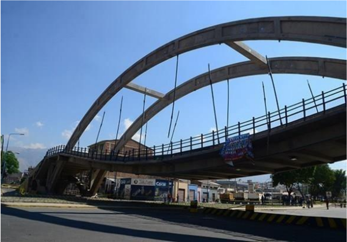
Figura 1. La plataforma del paso desnivel de la avenida 6 de Agosto e Independencia, en la zona sur, se hunde luego que uno de los tirantes se desprendió. – José Rocha Los Tiempos
