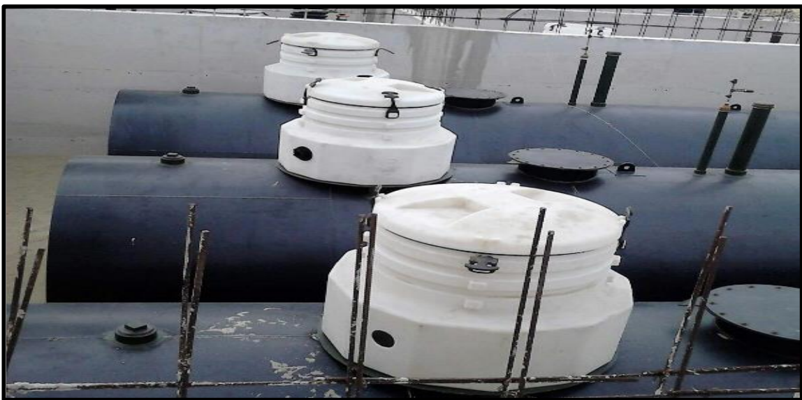
Figura 14. Tanques de polietileno
