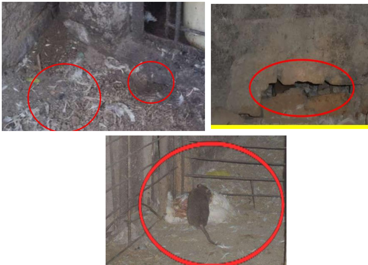
Imagen 3. Infraestructura inadecuada de los puestos que condicionan la presencia de madrigueras de roedores.
