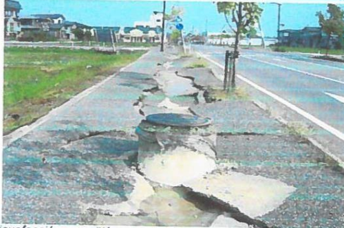
La licuefacción permitió que esta boca de alcantarilla flotara y se elevara por sobre la superficie (Imagen tomada de: http://es.wikipedia.org )
