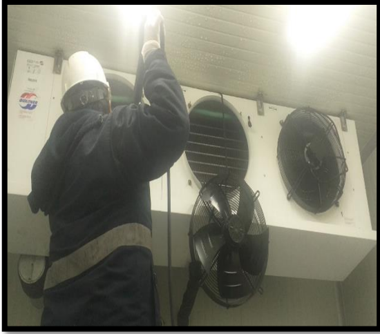
Figura 18. Mantenimiento de evaporadores
