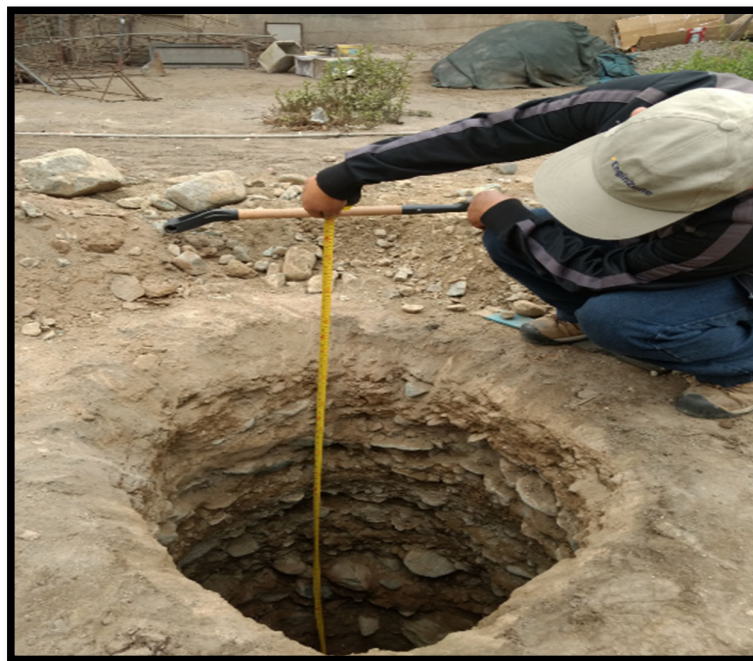
Fotografía N° 10: primera calicata en el colegio Antonia Moreno de Cáceres Se excavó a cielo abierto una profundidad de 3,00 m.
