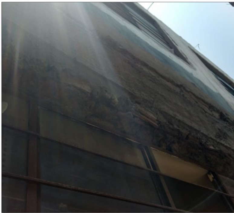
Fotografía N° 31: acero expuesto a lo largo de la viga V - P1
