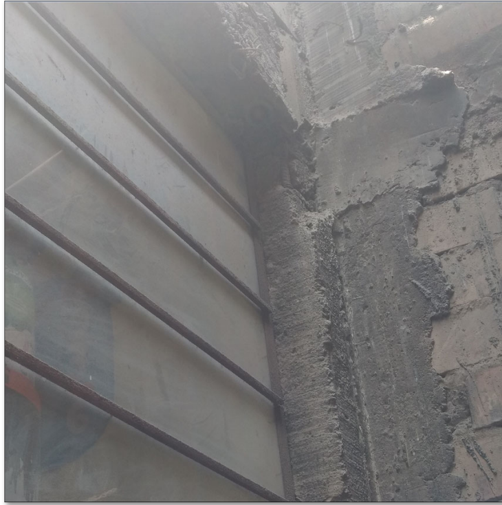
Fotografía N° 26: Acero expuesto en la columna C-2 (eje A-7)
