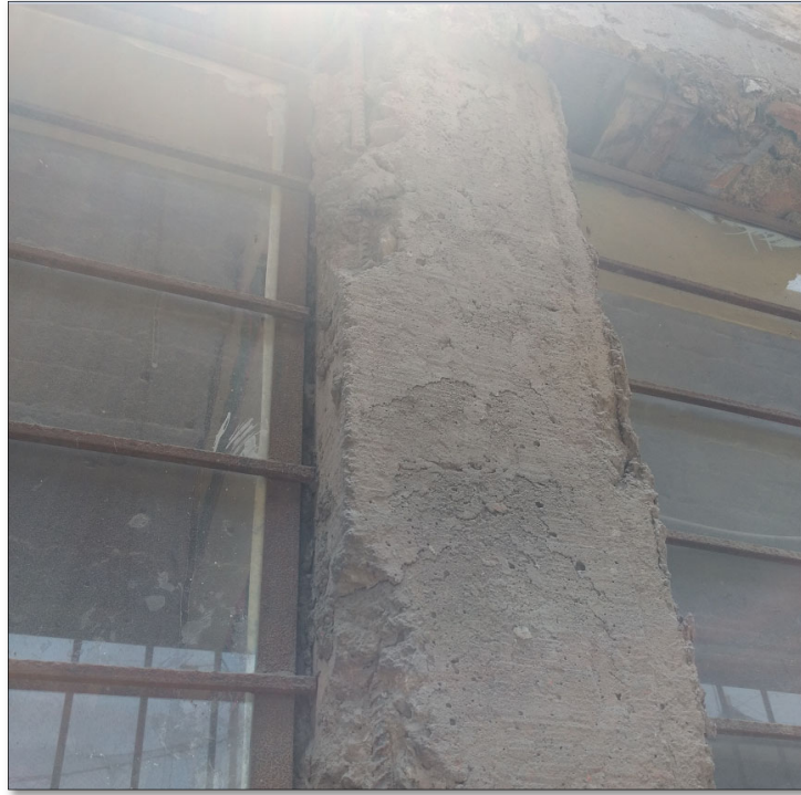
Fotografía N° 28: Acero expuesto en la columna C-1 (eje A-5)
