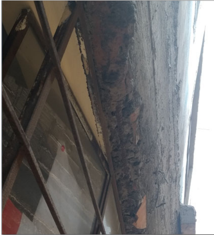
Fotografía N° 32: acero expuesto a lo largo de viga V - P1
