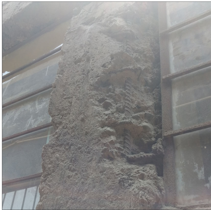
Fotografía N° 27: Acero expuesto en la columna C-2 (eje A-6)
