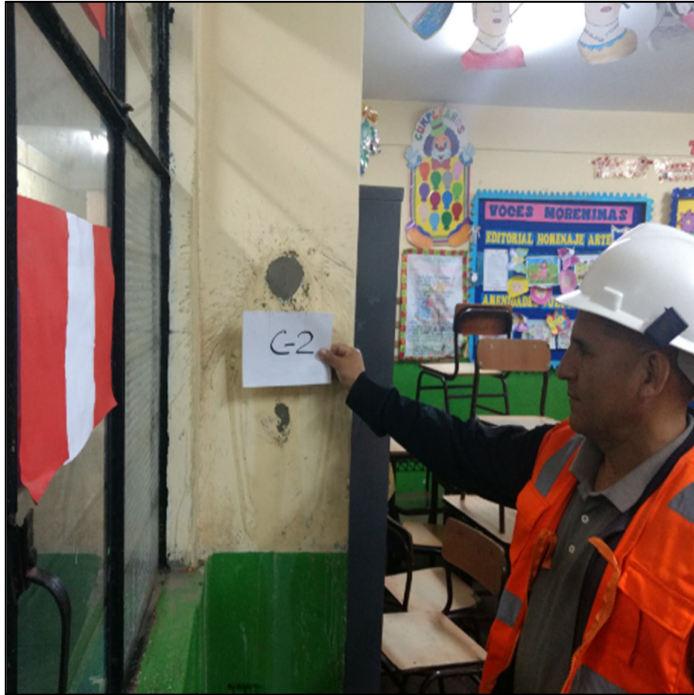
Fotografía N° 15: perforación para la obtención del testigo diamantino C-2 en la columna del 1° piso del pabellón B de la I.E. Antonia Moreno de Cáceres.
