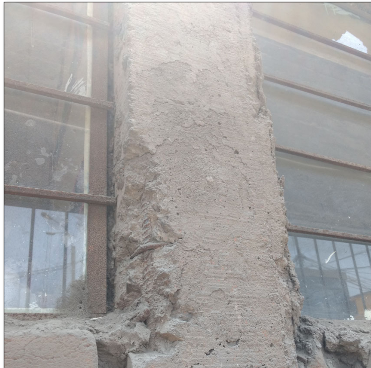
Fotografía N° 29: Acero expuesto en la columna C-2 (eje A-4)
