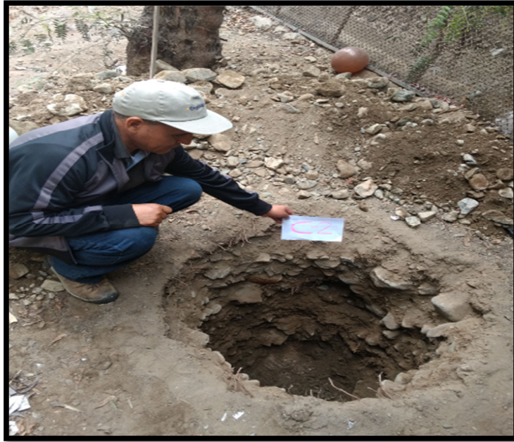
Fotografía N° 11: segunda calicata en el colegio Antonia Moreno de Cáceres Se excavó a cielo abierto una profundidad de 3,00 m.
