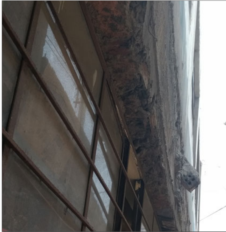
Fotografía N° 30: acero expuesto a lo largo de la viga V - P1
