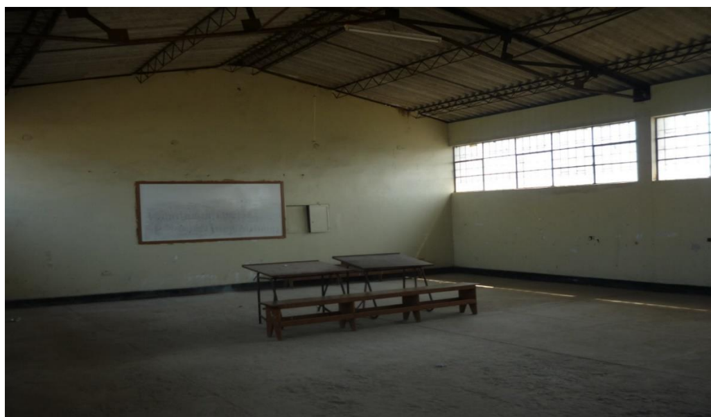
Figura N°23. Precario Estado de algunos Ambientes destinados como Laboratorios, los cuales no cuentan con Mobiliario adecuado para poder realizar clases.
