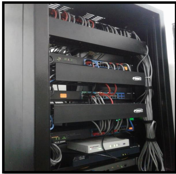
Figura 26 Data Center del Edificio Morphology
