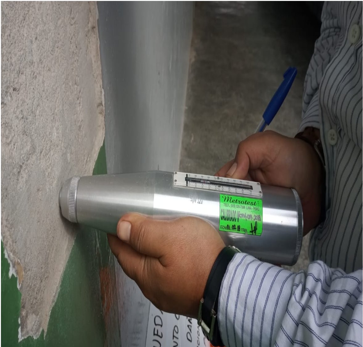
Figura 19. Ensayo de esclerometría.
