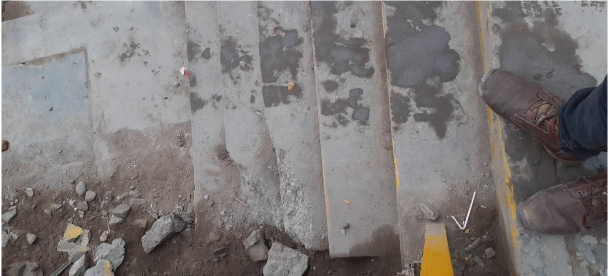
Figura 13. Vista de escalera se puede observar pasos destruidos
