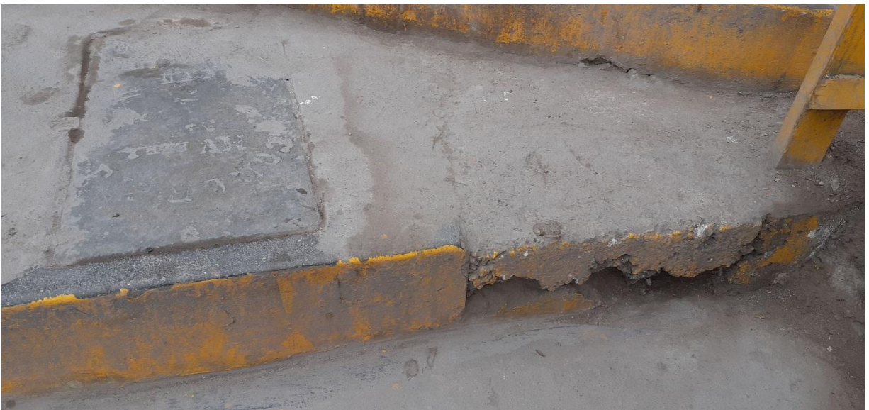
Figura 18. Vista de escalera n°1648 pasaje 9-7. problemas de desintegración
