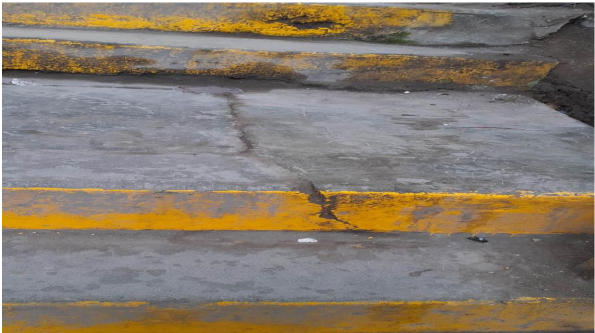
Figura 14. Vista de fallas por agrietamiento de escalones (pasos y contrapasos)
