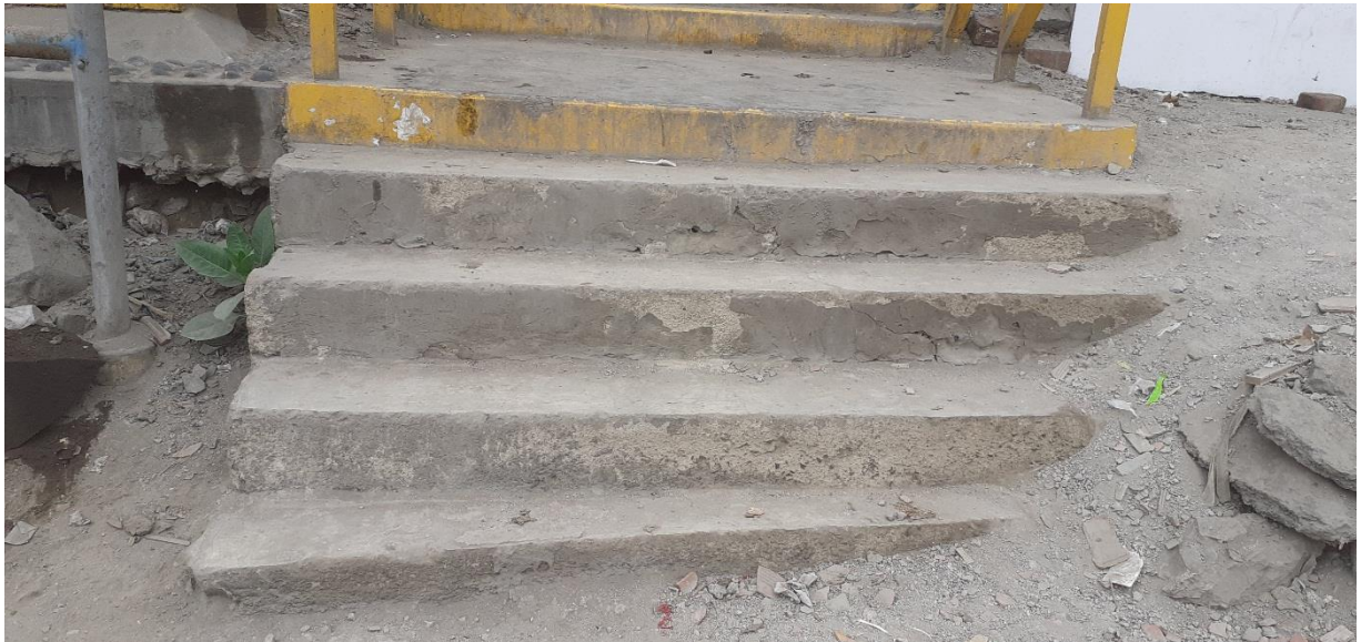
Figura 17. Vista de escalera n°1648 pasaje 9-7. problemas de desintegración.
