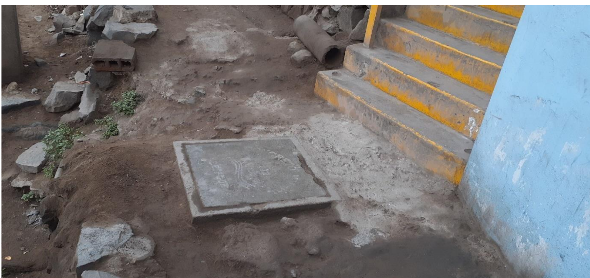
Figura 12. Vista de final de mal acceso a escalera donde se visualiza un gran deterioro y peligro.
