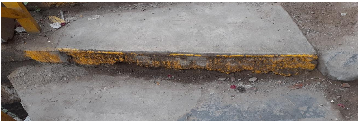
Figura 4. Vista de escalera con problemas de rajadura en el contrapaso, escalera del programa “Solidaridad” elaborada en el año 2008.
