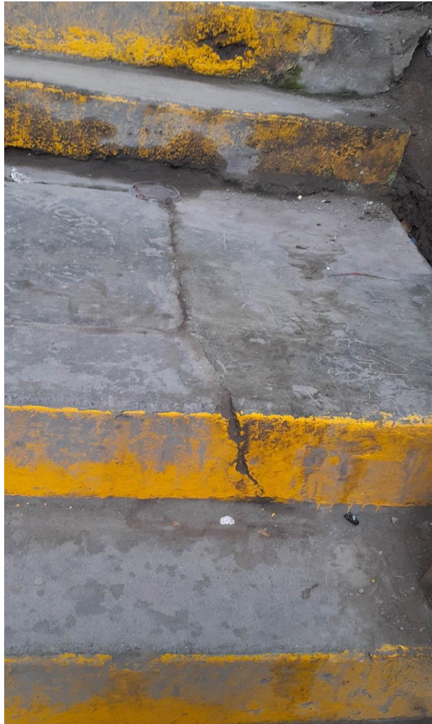
Figura 19. Vista de Fisuramientos en escalera n°1648
