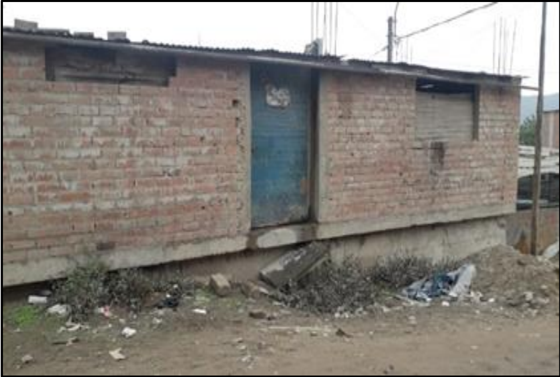
Vivienda de albañilería sin la presencia de vigas
