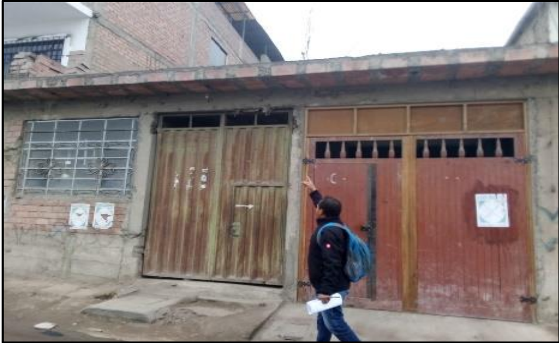
Defecto de edificación de techo sin la presencia de acero
