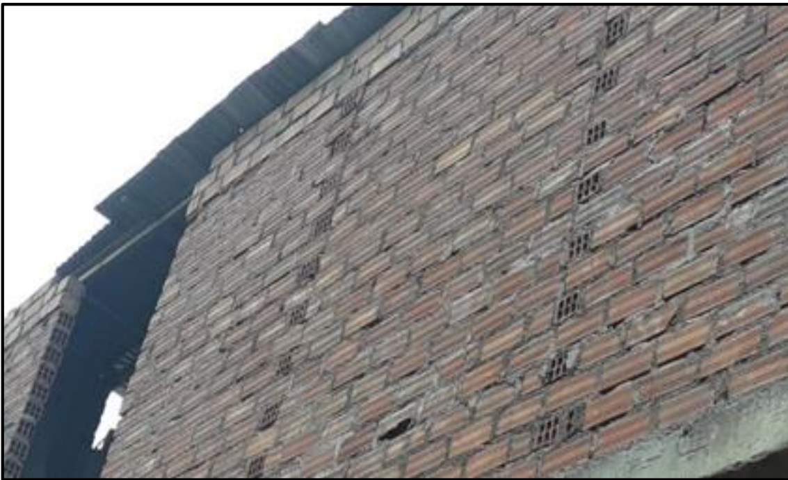
Falta de confinamiento de muro
