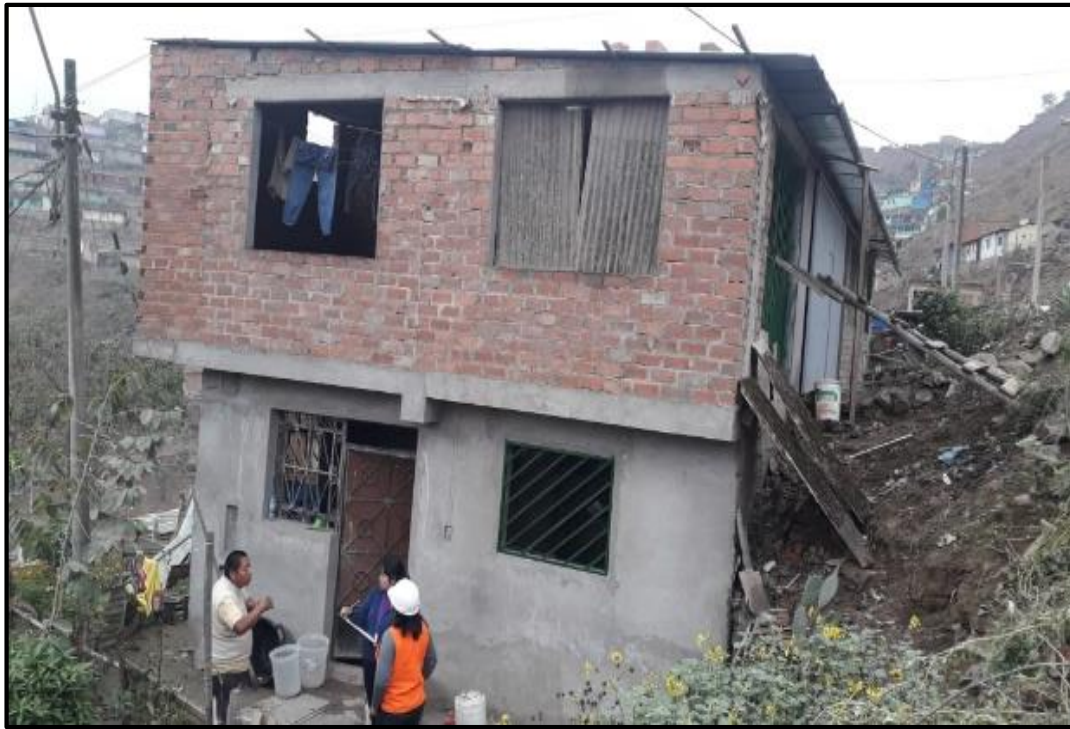
Consideración estructural de la viga superior sin continuidad
