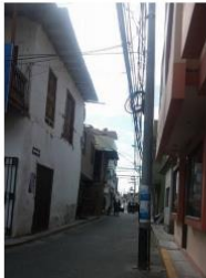
Acumulación de claves eléctricos
