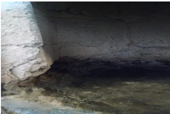
Refractario de cámara primaria deteriorado
