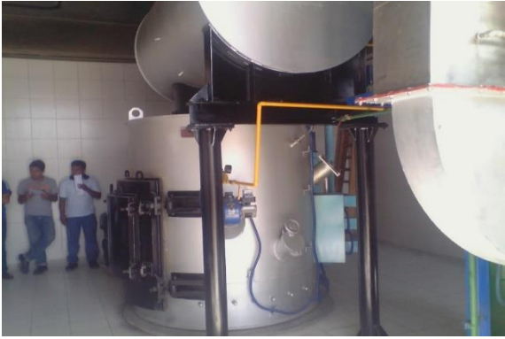
Equipo incinerador pirolítico funcionando y eficiente
