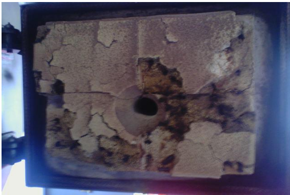
Refractario de puerta de cámara secundaria deteriorado
