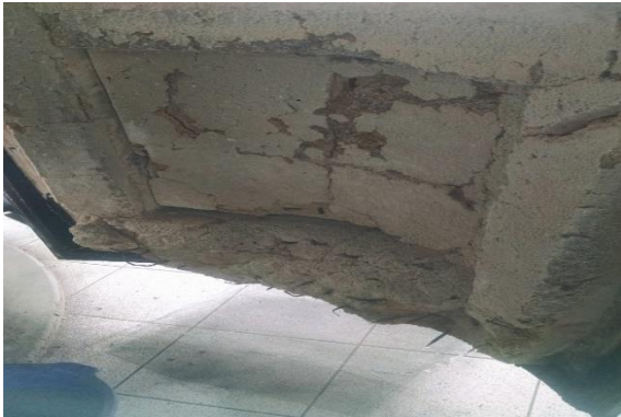
Refractario de puerta de cámara primaria deteriorado
